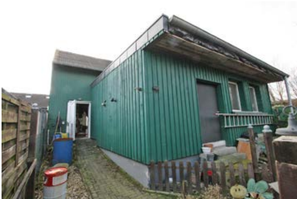
Bild 7: Rückansicht der Werkstatt mit der ohne Genehmigung errichteten Erweiterung aus nordöstlicher Richtung
