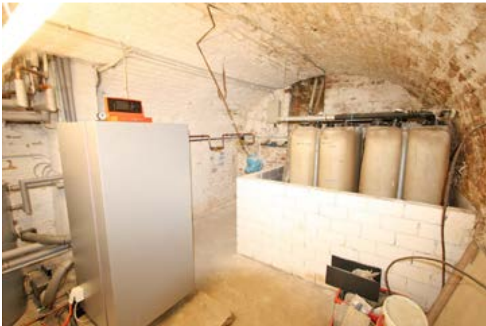
Bild 4: Keller des Wohnhauses mit Heizkessel (Contracting) und Öltanks
