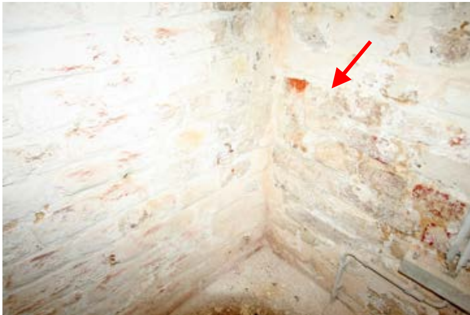
Bild 5: Feuchtigkeitsschäden an Kellermauerwerk des Wohnhauses
