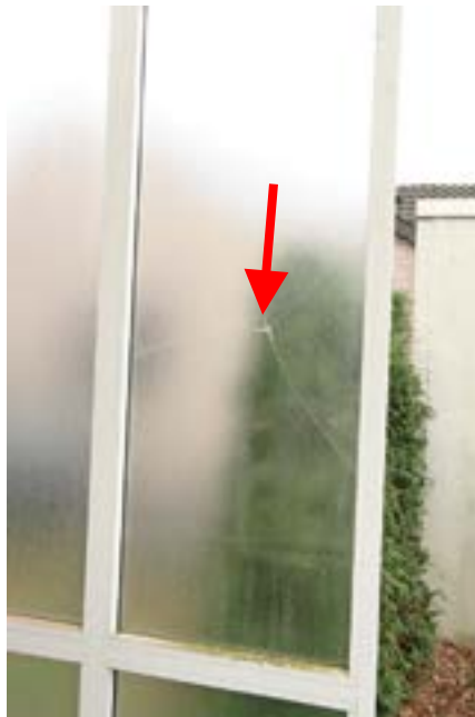
Bild 10: Schadhafte Glasscheibe in Terrassenwand
