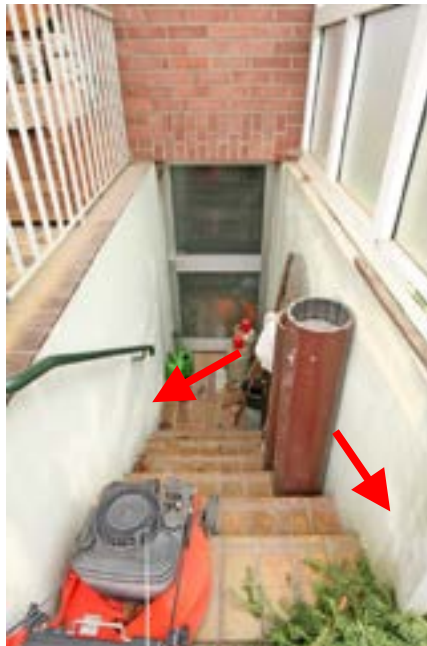
Bild 9: Kelleraußentreppe mit Feuchtigkeitsschäden an den Seitenwangen
