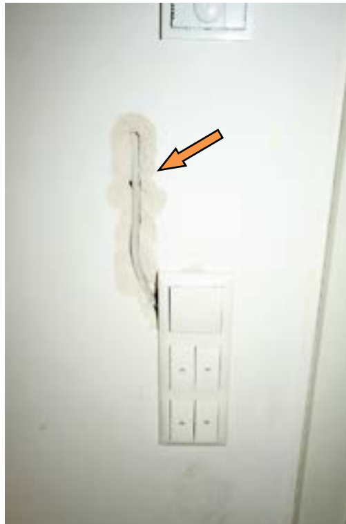
Bild 9: Schadhafter Wandputz am Lichtschalter im Schlafzimmer im Erdgeschoss des Bewertungsobjekts
