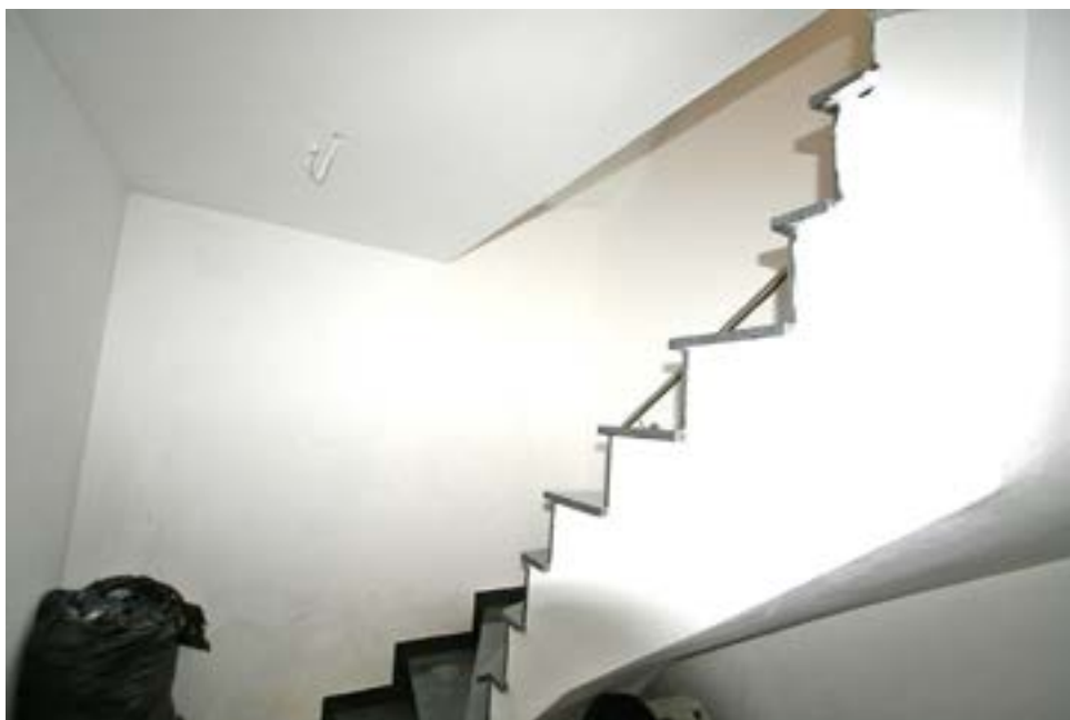
Bild 8: Fehlende Absturzsicherung an der Kellertreppe des Bewertungsobjekts
