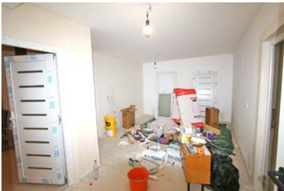
Bild 6: Ausbau- oder Instandsetzungsarbeiten in der Diele und im Abstellraum im Kellergeschoss des Bewertungsobjekts
