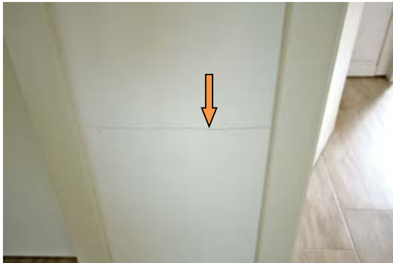
Bild 10: Wandriss im Dachgeschoss des Bewertungsobjekts
