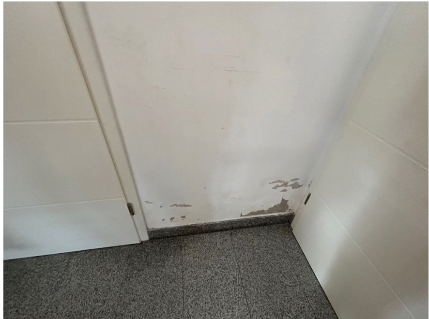
Schäden im Wandbereich der Erdgeschoßwohnung Haus Nr. 34
