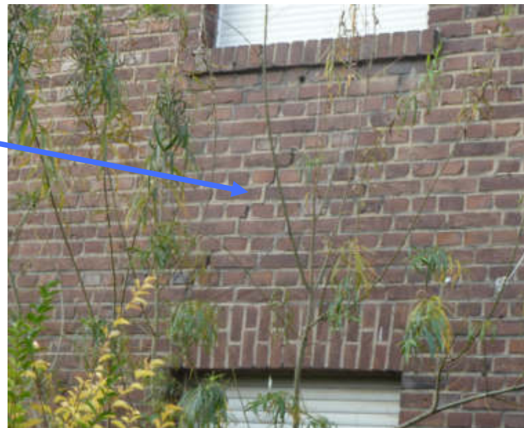
straßenseitig ebenfalls tlw. Risse innerhalb der Fassade sowie z.T. Fugen schadhaft, Vorgarten in einem vernachlässigten Zustand
