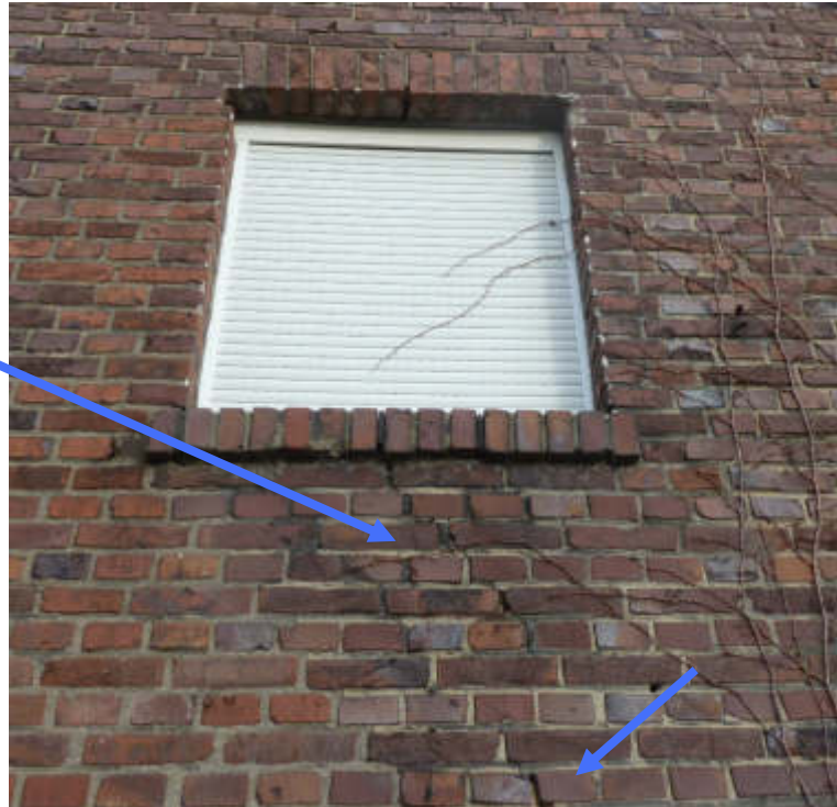
südliche Giebelseite tlw. Risse innerhalb der Fassade sowie z.T. Fugen schadhaft
