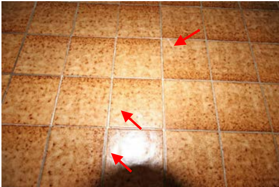
Bild 15: Schadhafter Fliesenbelag im Erdgeschoss (1)
