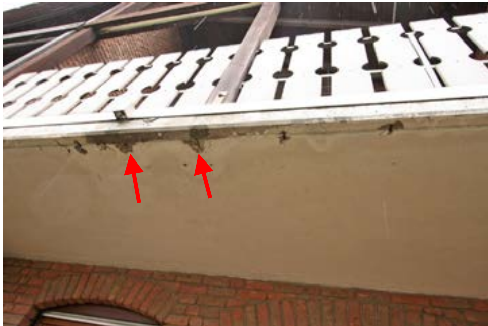
Bild 17: Betonabplatzungen an Balkonplatte
