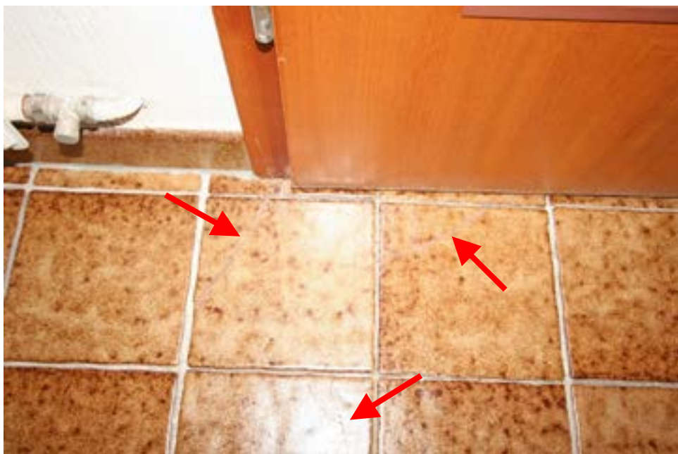
Bild 16: Schadhafter Fliesenbelag im Erdgeschoss (2)
