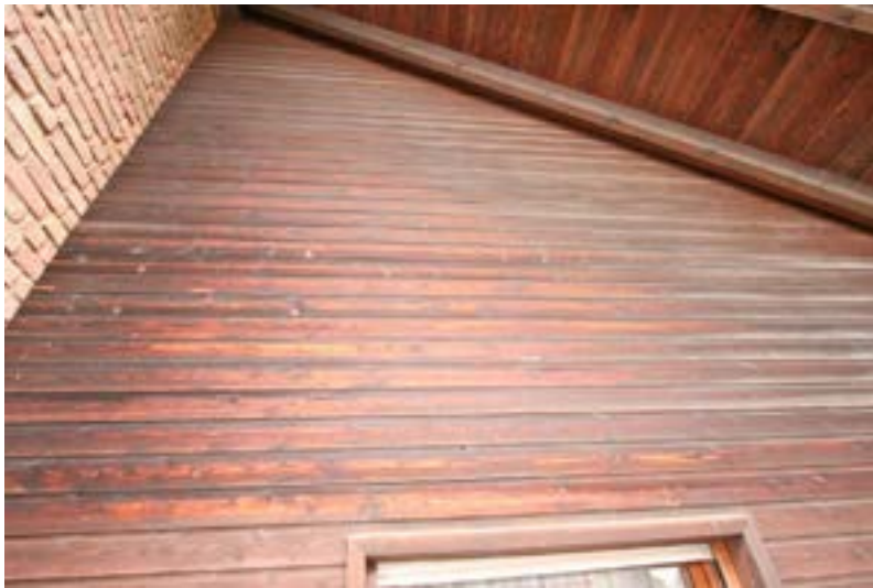
Bild 13: Verwitterungen der Holzverkleidung des Nordwestgiebels
