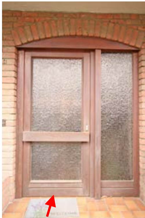
Bild 14: Verwitterungen der Holzeingangstüre
