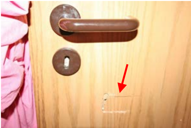
Bild 13: Schadhafes Türblatt in der Wohnung im Erdgeschoss des Hauses Nr. 151
