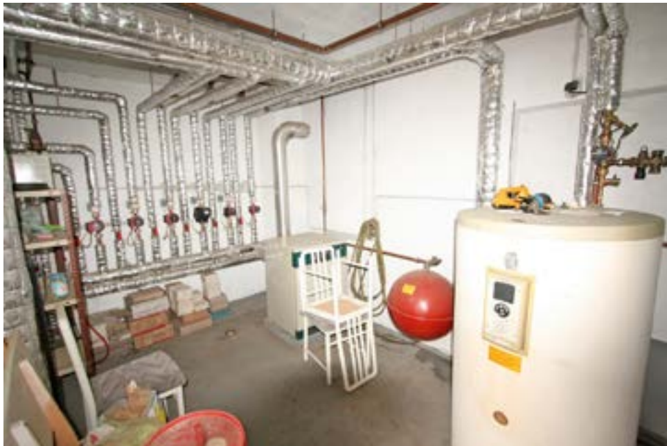
Bild 9: Heizungsraum in Anbau gemäß Bild 8
