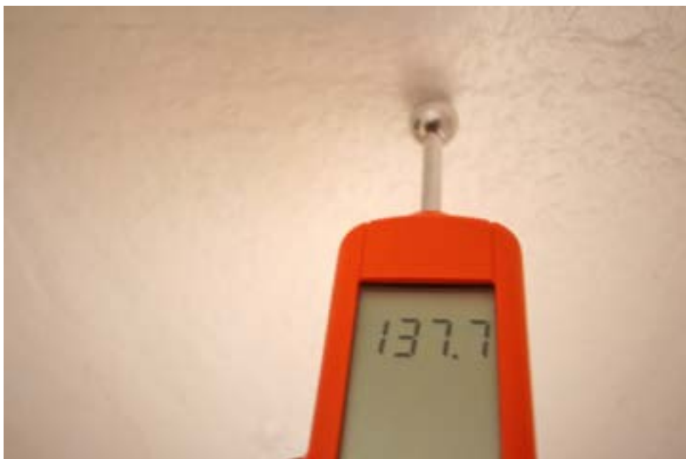
Bild 12: Feuchtigkeitsschaden an der nördlichen Außenwand von Haus Nr. 149, gemessen an der Innenseite der Außenwand
