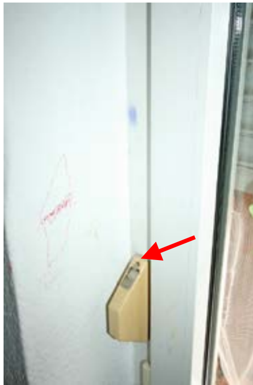
Bild 14: Schadhafter Rollladengurt in der Wohnung im Erdgeschoss des Hauses Nr. 151
