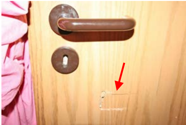
Bild 13: Schadhaftes Türblatt in der Wohnung im Erdgeschoss des Hauses Nr. 151
