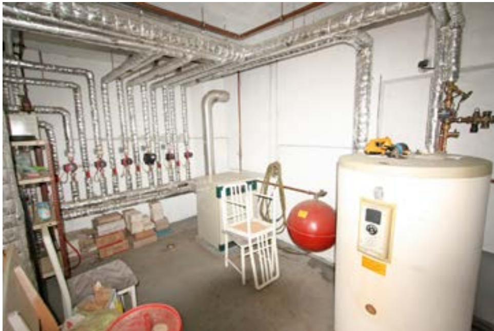
Bild 9: Heizungsraum in Anbau gemäß Bild 8
