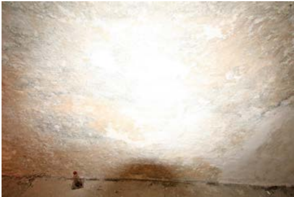
Bild 11: Feuchtigkeitsschaden an Kellermauerwerk von Haus Nr. 149
