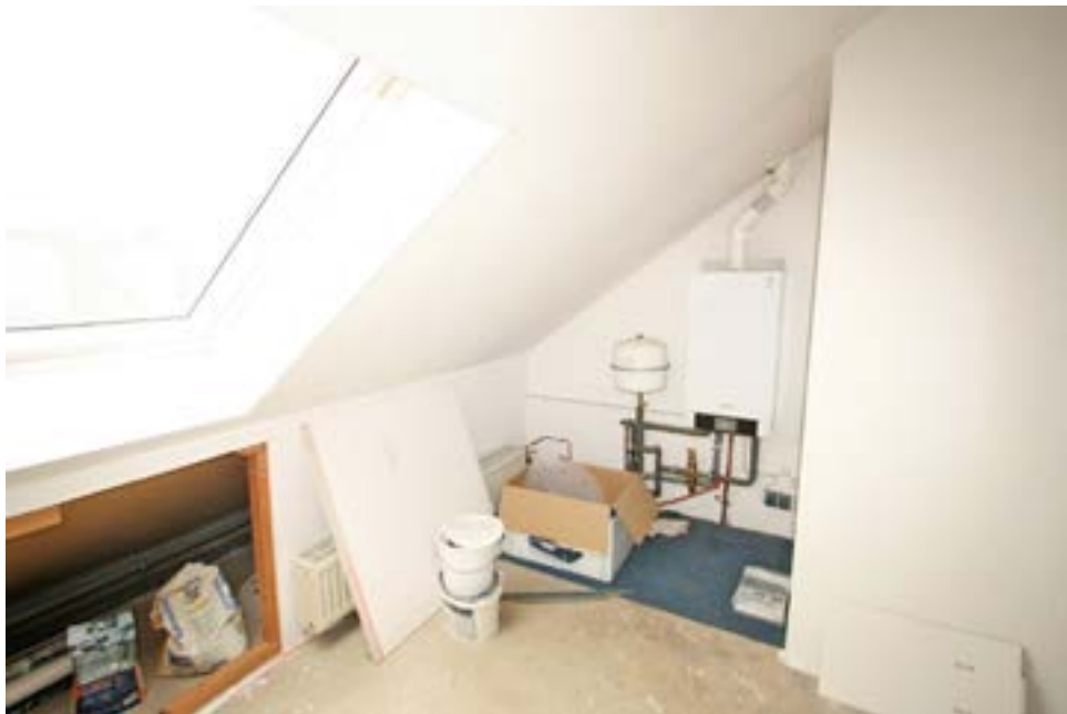
Bild 14: Nische mit Heizkessel im straßenseitigen Raum im Dachgeschoss des Bewertungsobjekts
