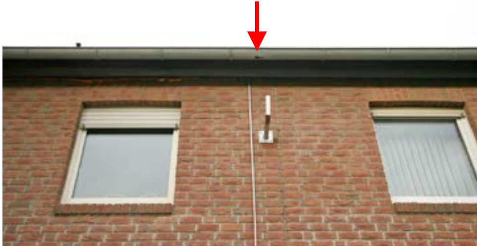
Bild 19: Schadhafte gartenseitige Dachrinne des Bewertungsobjekts
