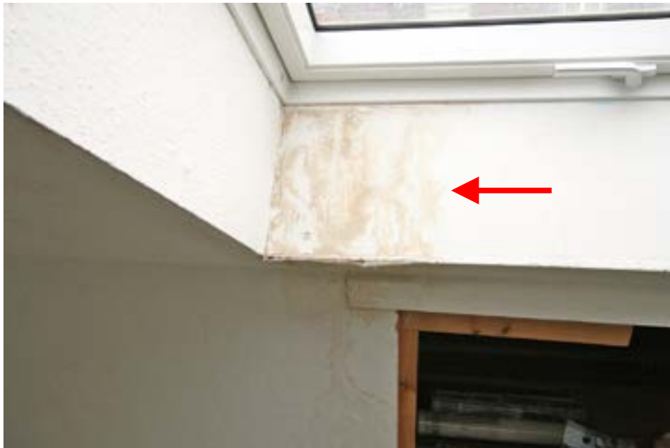
Bild 15: Feuchtigkeitsfolgeschaden unterhalb des Dachflächenfensters im straßenseitigen Raum im Dachgeschoss des Bewertungsobjekts
