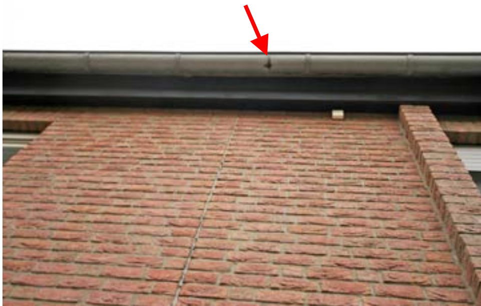
Bild 18: Schadhafte straßenseitige Dachrinne des Bewertungsobjekts
