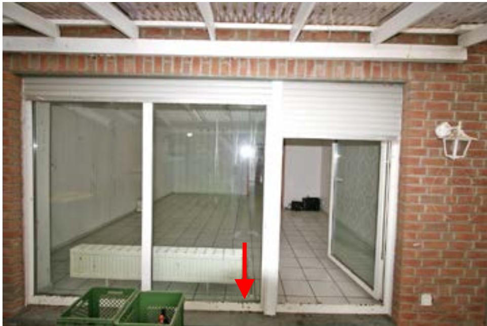
Bild 17: Kotpuren am Wohnzimmerfenster als Hinweis auf Schädlingsbefall im Rollladenkasten des Bewertungsobjekts
