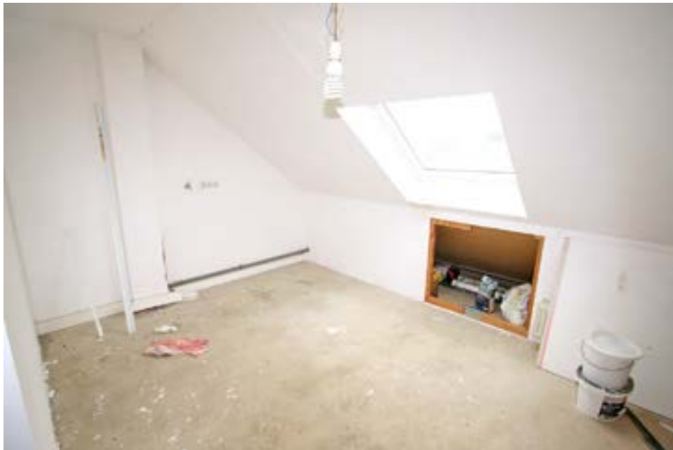
Bild 13: Straßenseitiger Raum im Dachgeschoss des Bewertungsobjekts, Oberbodenbelag fehlt
