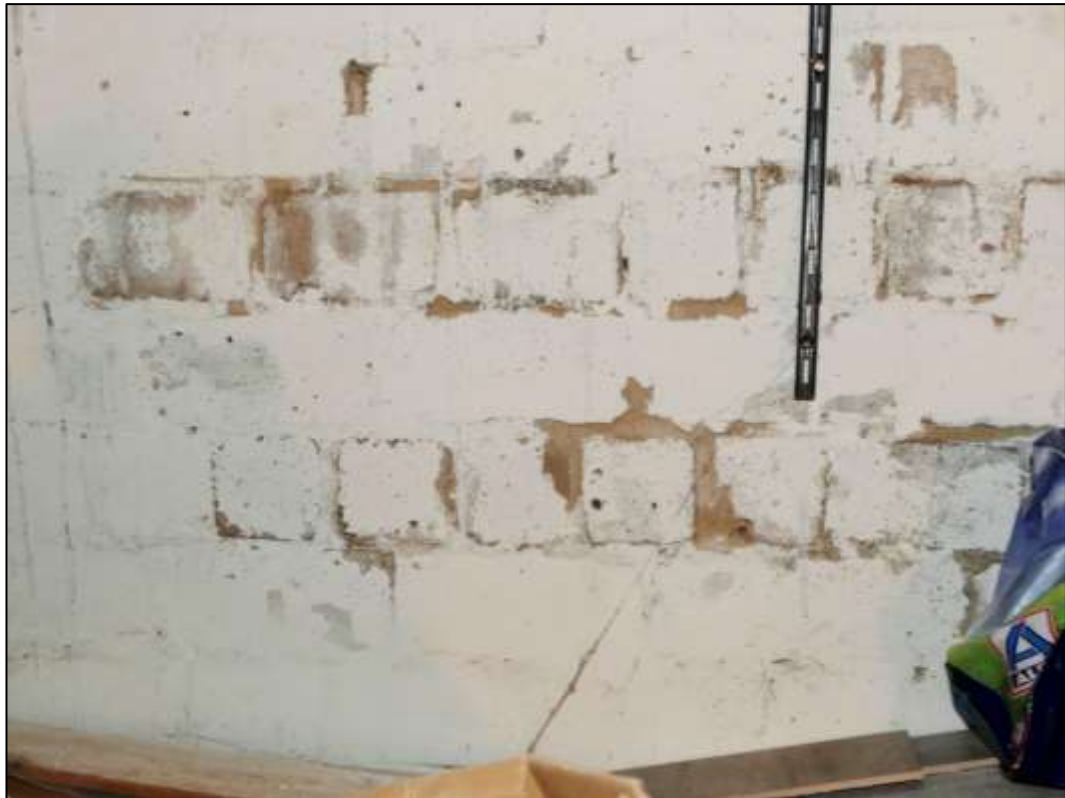
Feuchtigkeitsschäden im Kellergeschoss
