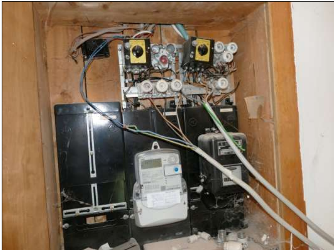
Elektro-Installation technisch überaltert
