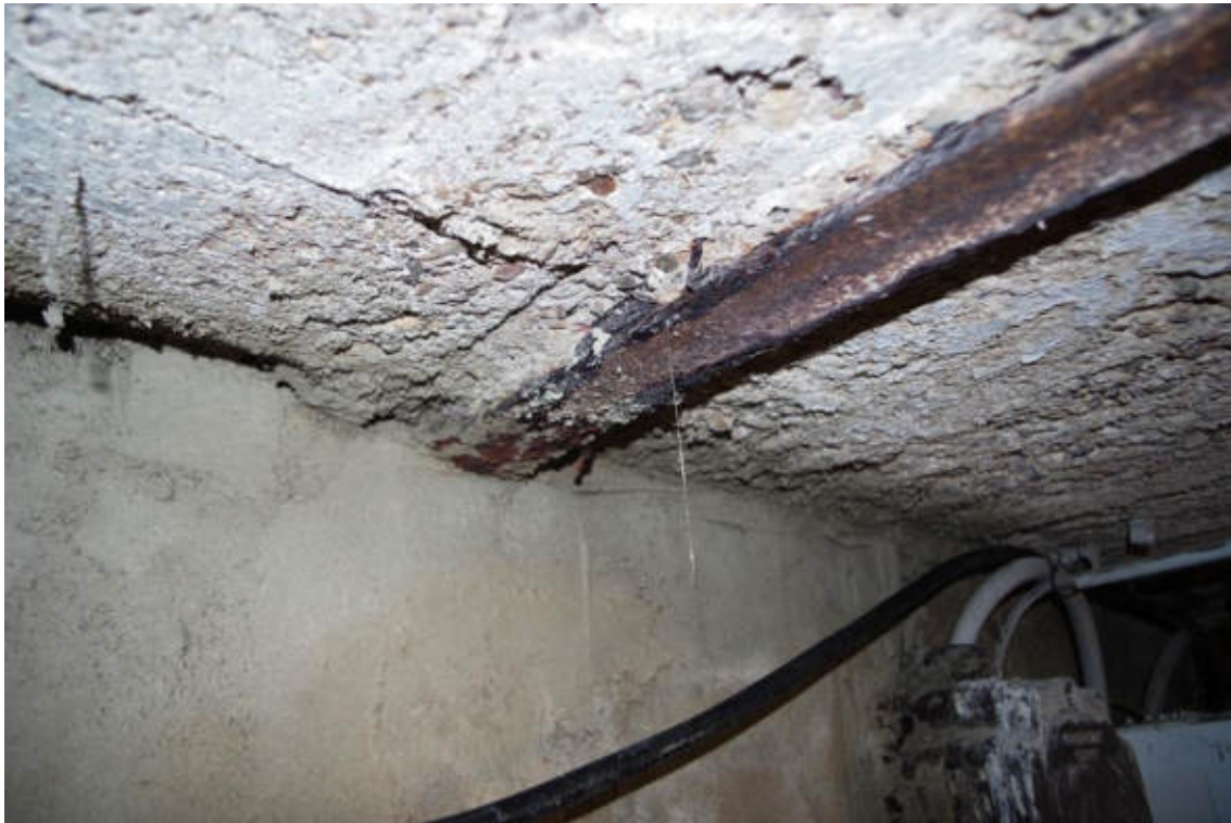
Bild 32: Detailansicht der sanierungsbedürftigen Stahlträger im Bereich der Kellerdecke
