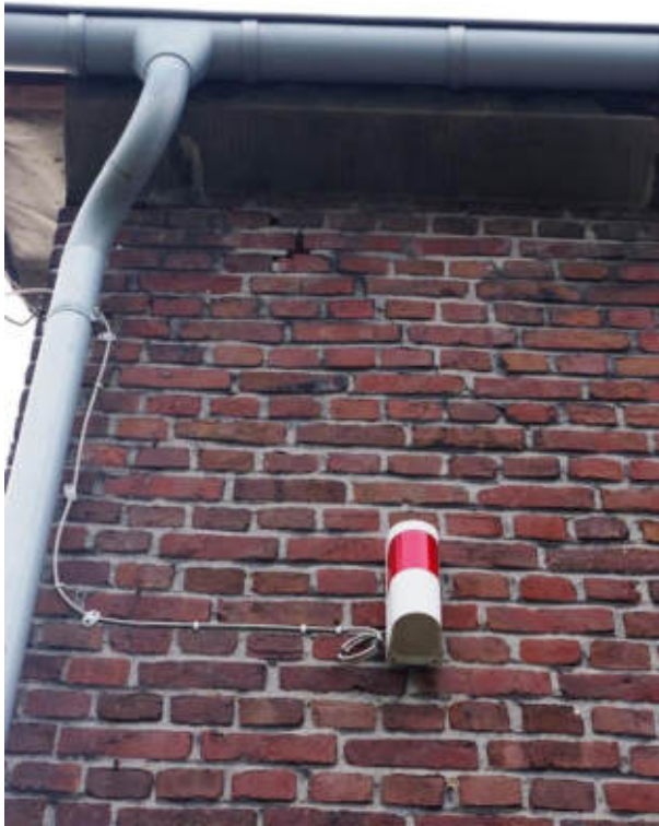
Bild 36: Detailansicht Riss im Außenmauerwerk
