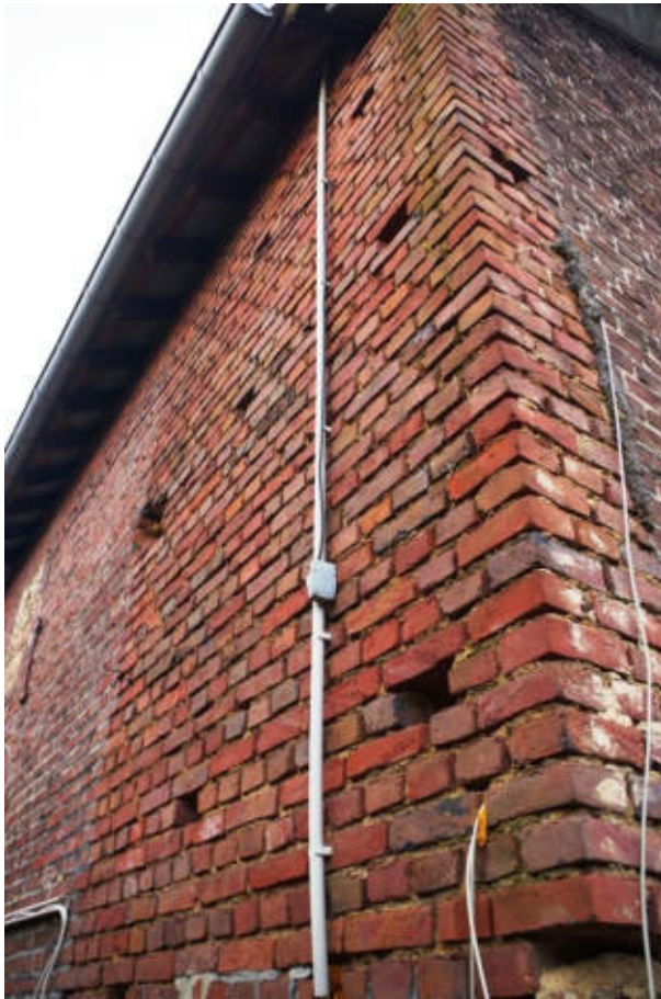
Bild 34: Detailansicht der sanierungsbedürftigen Fassade
