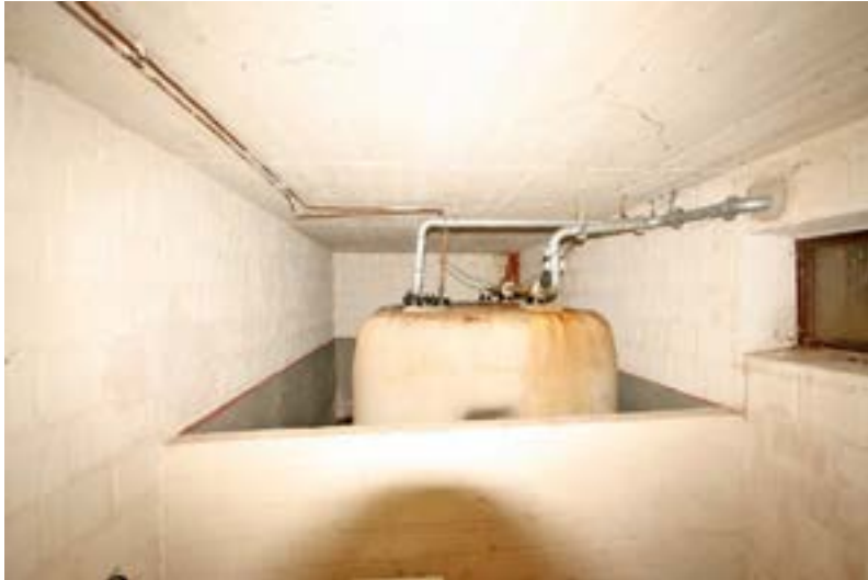
Bild 7: Heizöllagerraum im Kellergeschoss des Bewertungsobjekts
