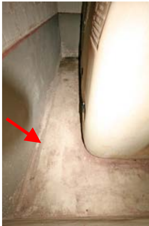
Bild 8: Fehlender bzw. abgenutzter Schutzanstrich auf dem Boden der Ölauffangwanne unterhalb der Öltanks
