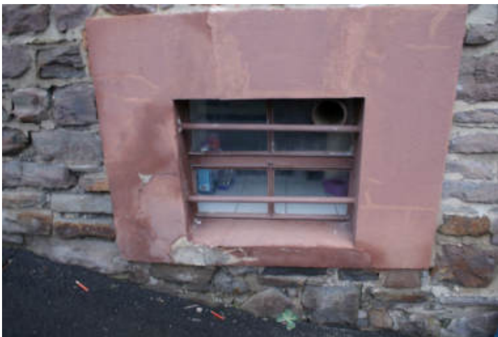
Bild 54 Schäden im Bereich der Fensterfaschen Rückseite
