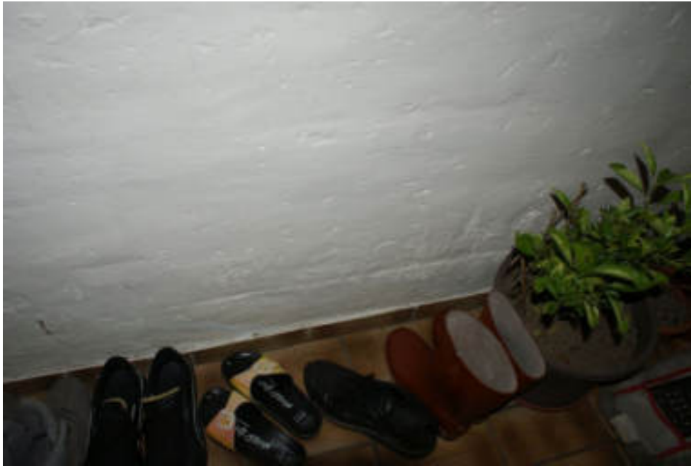
Bild 69 Beispiel für Putzschäden in den Wohnebenen
