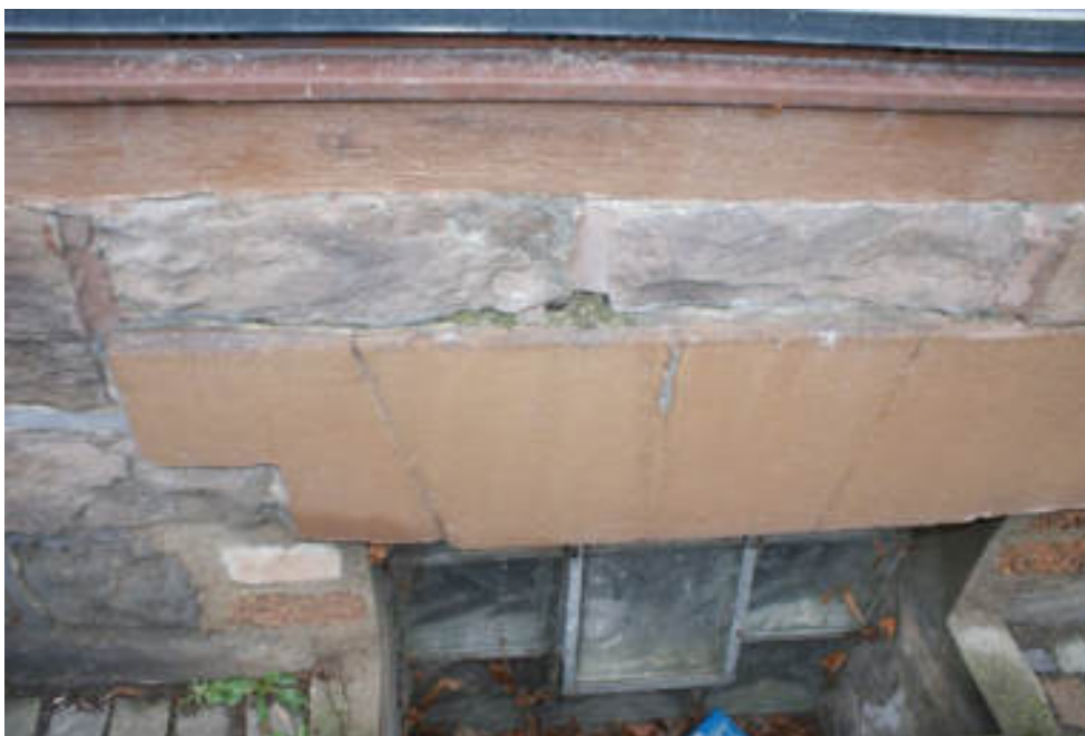
Bild 48 Beispiel für Mauerwerksschäden Bruchstein frontseitig
