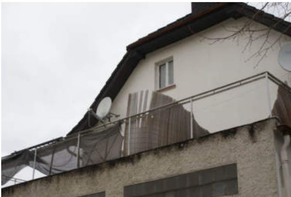
Bild 57 Nässeschäden vom Balkon Anbau / desolate Balkonbrüstung
