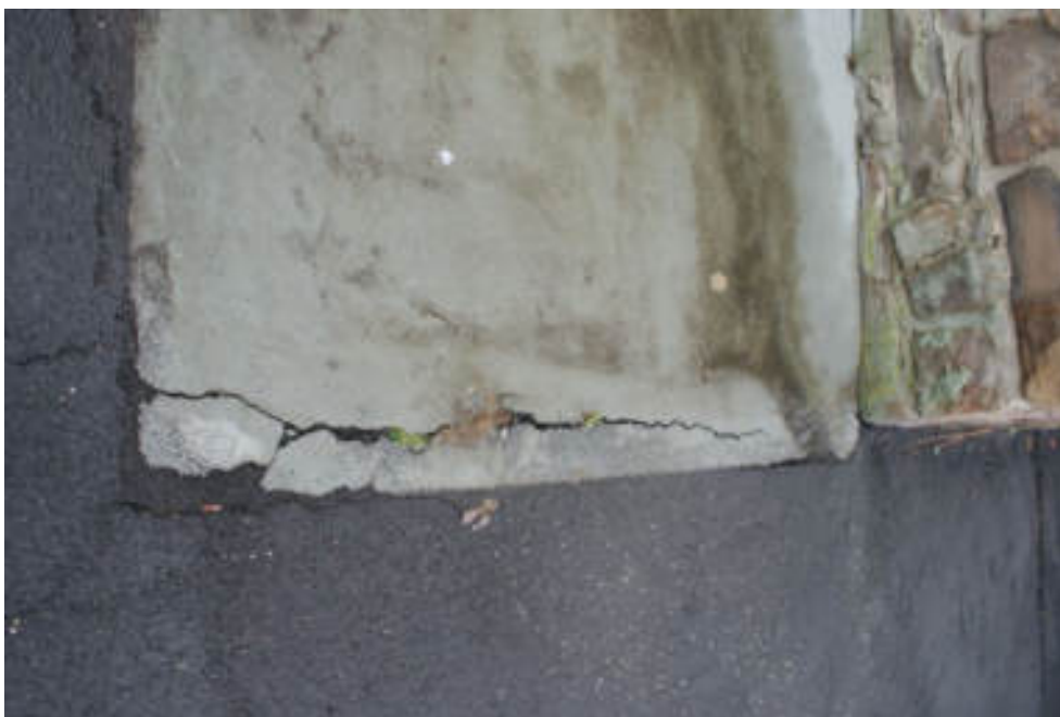
Bild 62 Betonschäden am Zugang zum UG
