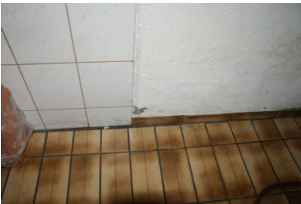
Bild 66 Beispiel für Feuchte- und Putzschäden im KG
