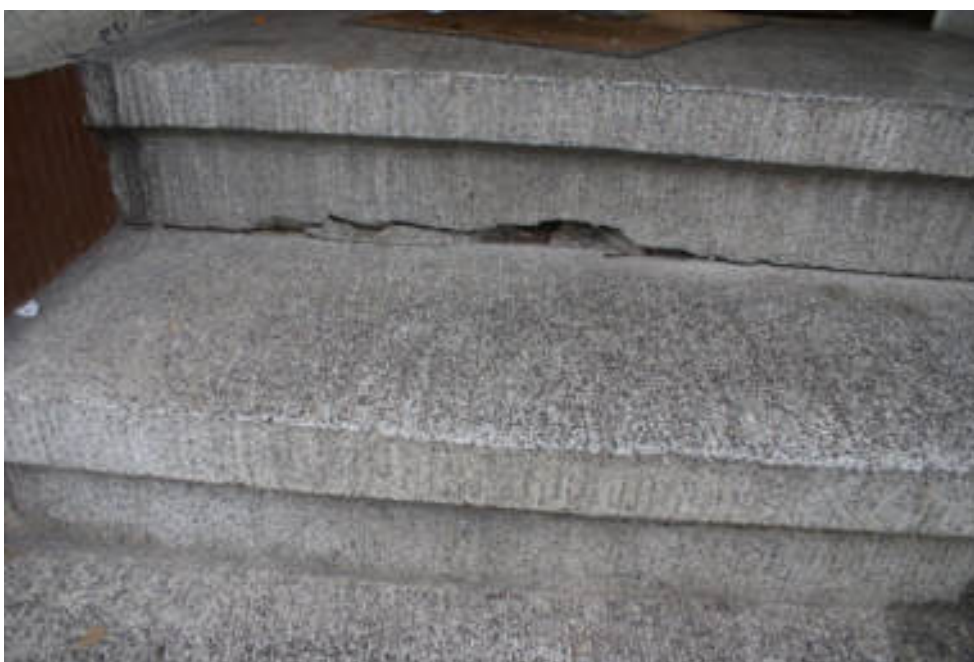
Bild 50 Starke Beschädigung der Natursteinstufen Hauseingang
