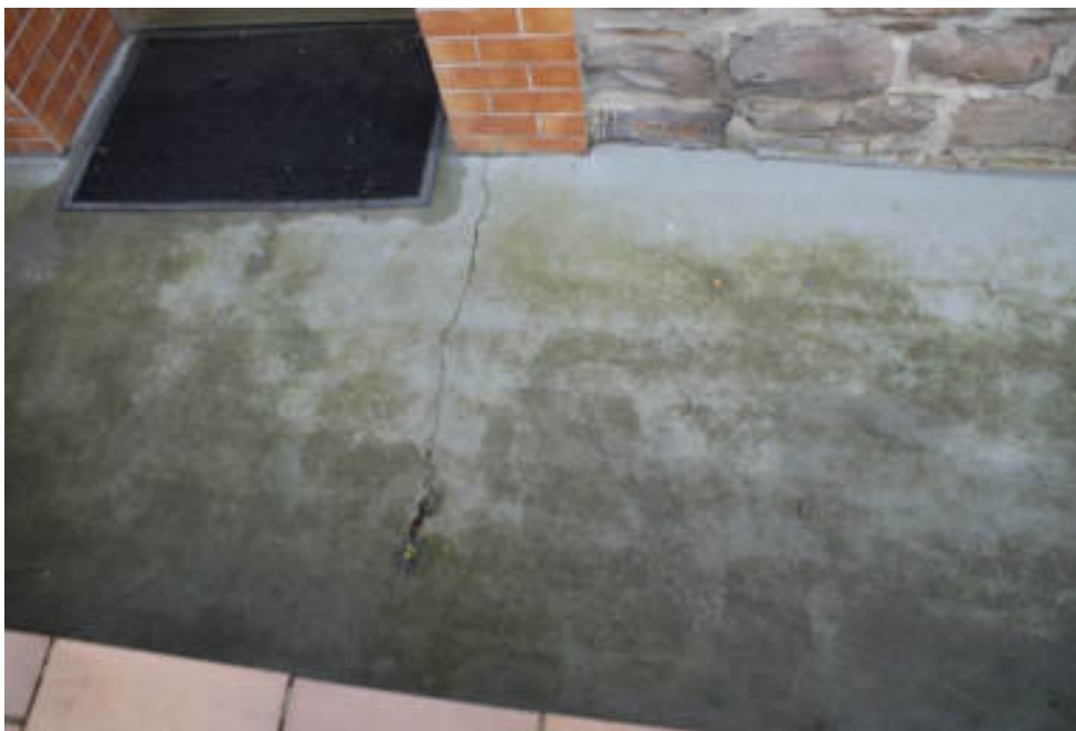
Bild 63 Riss im Beton des Zugangs zum UG
