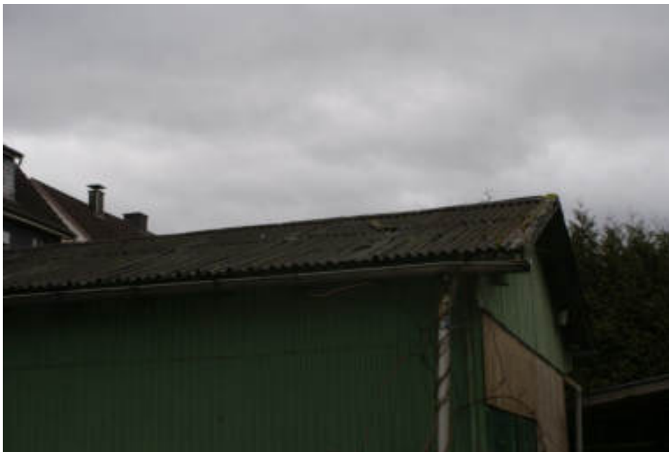
Bild 70 Schadhafes Dach und Dachentwässerung Carport
