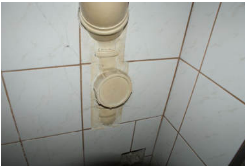
Bild 67 Fliesenschäden im Heizungskeller / alte Abwasserleitungen
