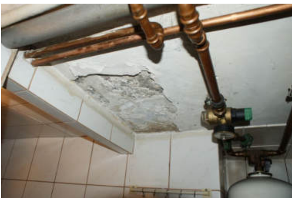
Bild 68 Beispiel für Putzschäden Betonkappendecke im KG
