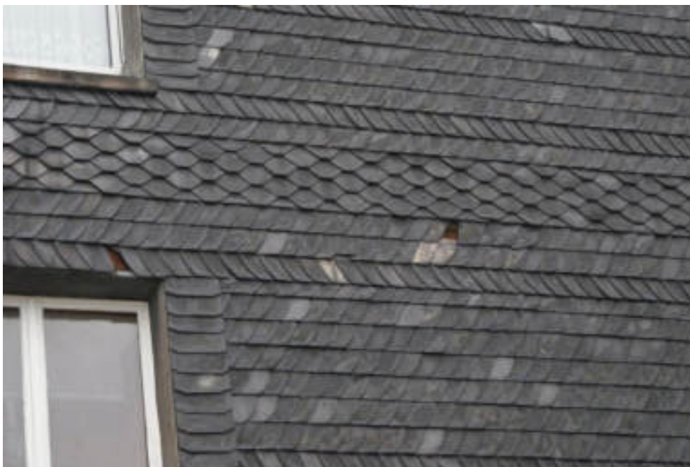
Bild 59 Weiter Schäden an der Verschieferung
