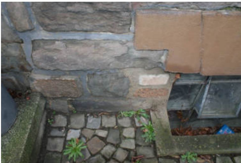
Bild 49 Weitere Schäden Bruchsteinsockel
