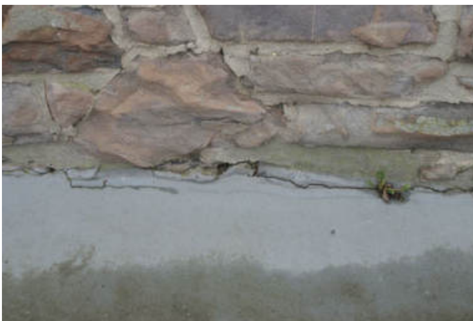
Bild 64 Nässeschäden am Betonweg zur Haustür UG
