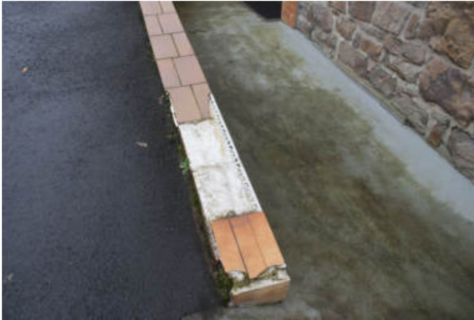
Bild 61 Stark schadhafte Stützmauer am Zugang zum UG
