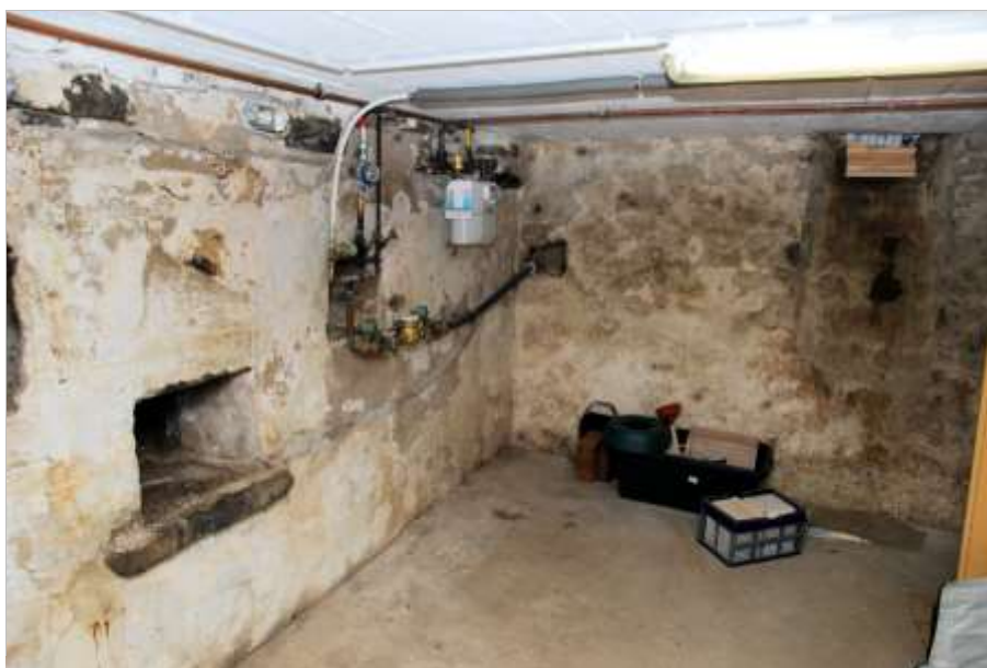
Foto 28 Geiningen 31, Kellergeschoss, Raum unter der Küche mit Hausanschlüssen
