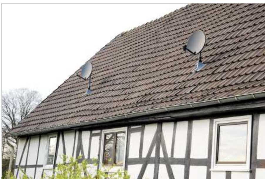
Foto 6 Geiningen 31, Dach auf der Südseite
