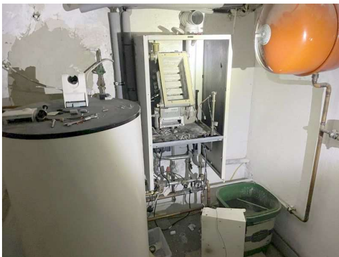
Heizung im Kellergeschoss des Altbaus
