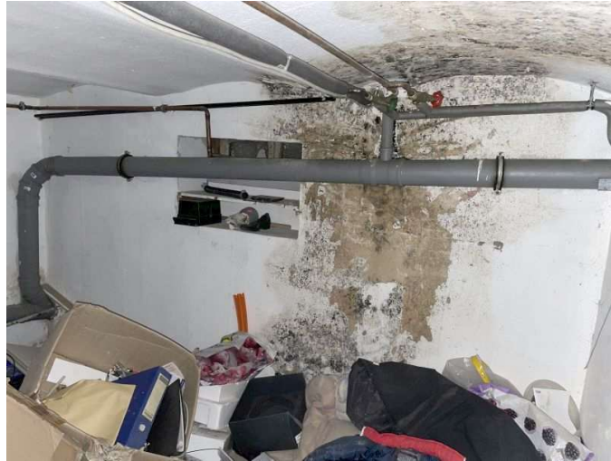
Feuchtigkeitserscheinungen im Kellergeschoss des Altbaus
