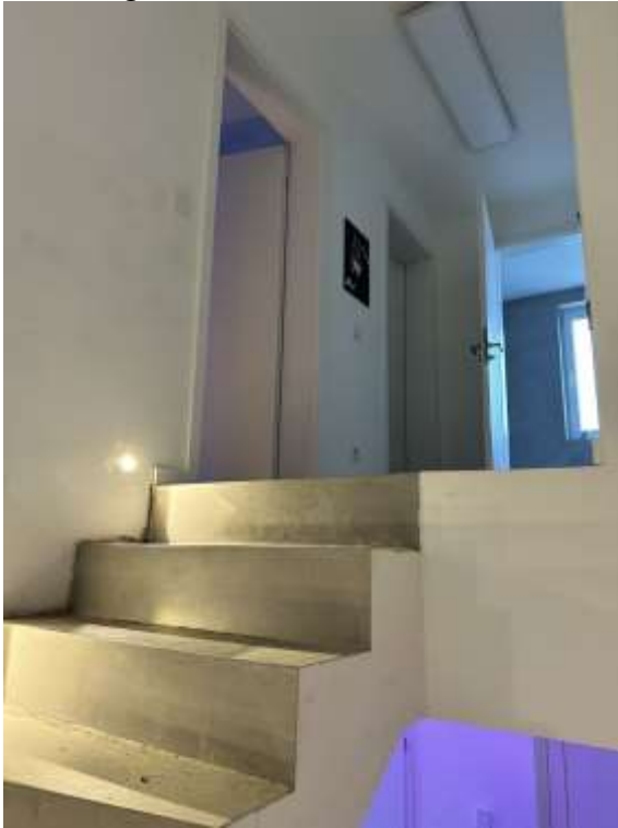
Treppe ohne Geländer
