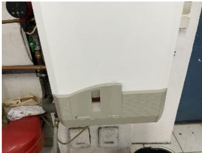
Gastherme im Sockelgeschoss
