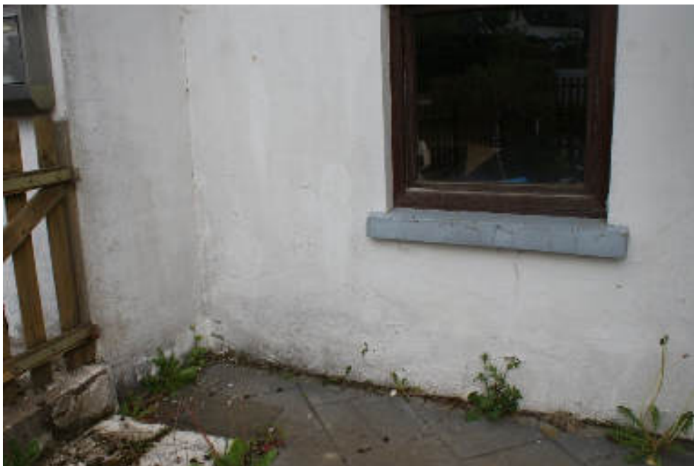
Bild 64 Putzschäden am Sockel und zur Garage vorne
