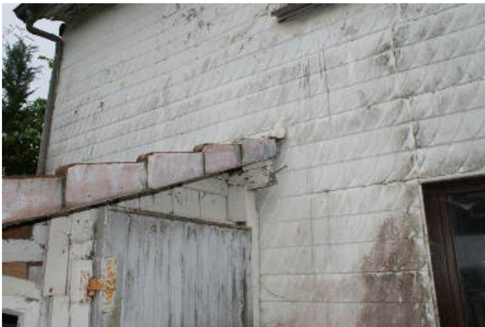
Bild 68 Schäden am Anbau zum Schuppen
