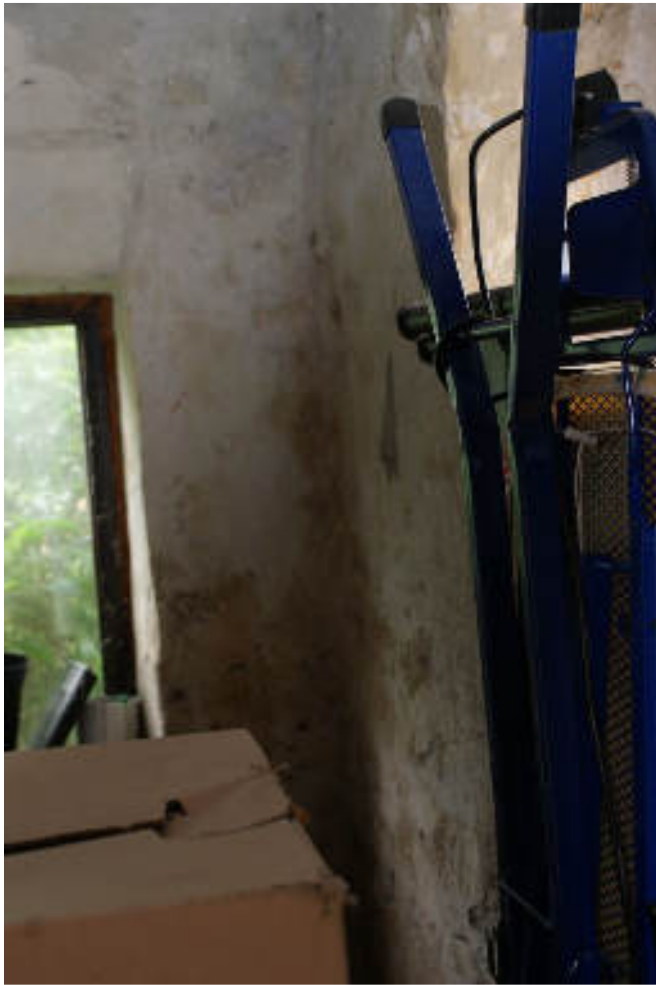
Bild 79 Starke Feuchte und Mauerrisse + Schimmel
