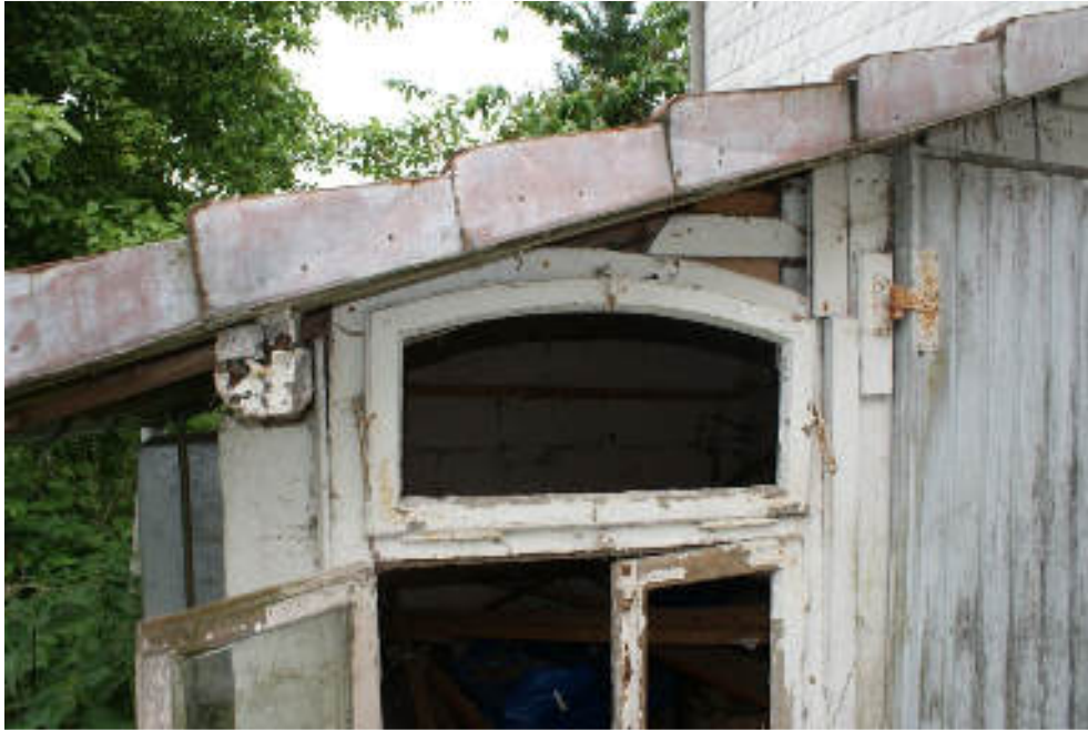
Bild 69 Desolater alter Schuppen, abgängig
