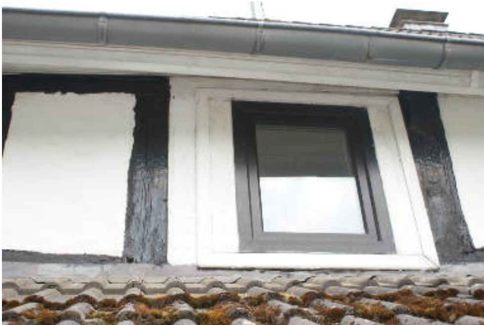
Bild 57 Fachwerkschäden OG Vorderhaus
