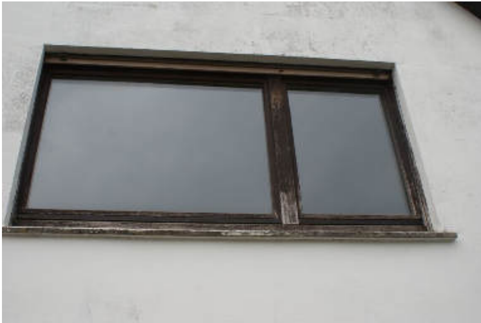
Bild 61 Beispiel für verwittertes altes Holzfenster
