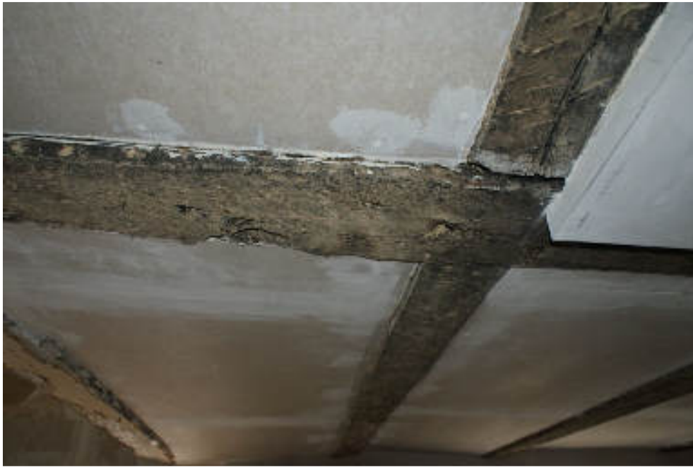
Bild 75 Beispiel für marode Deckenbalken im Vorderhaus
