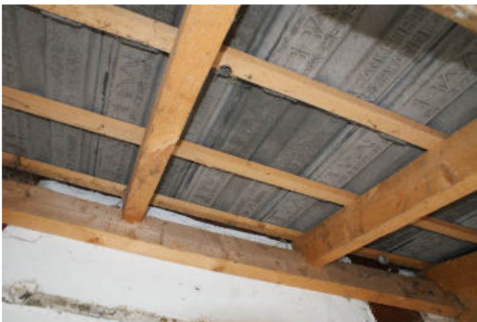
Bild 54 Ungedämmtes offenes Dach des Windfangs
