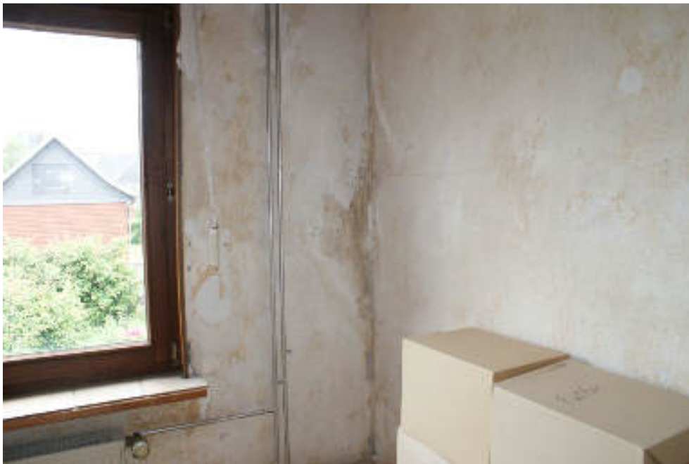
Bild 85 Aufputzinstallation und Feuchte /Risse in der Ecke
