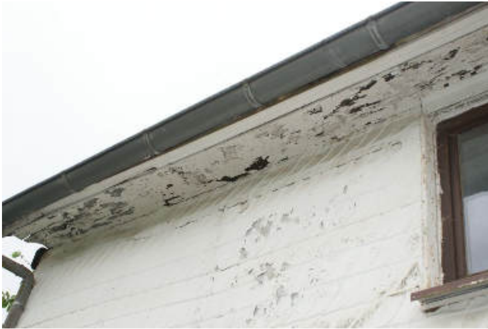
Bild 67 Beispiel für Schäden am Holzwerk, hier am Anbau
