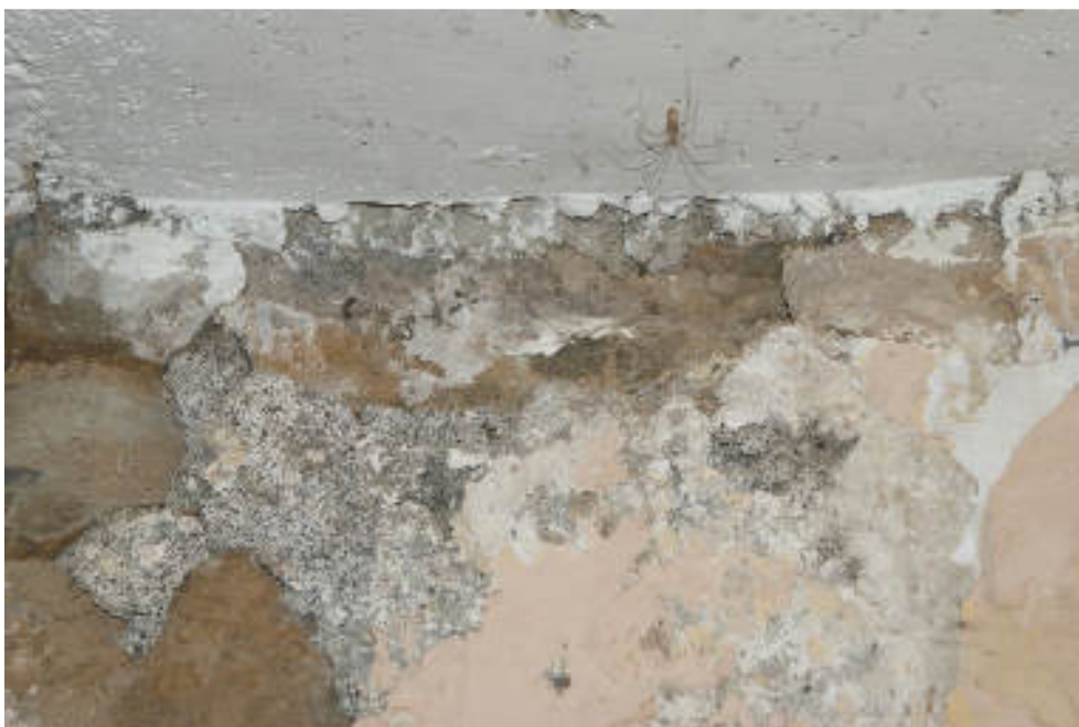
Bild 80 Putzschäden mit Schimmelbildung an alter Steinmauer
