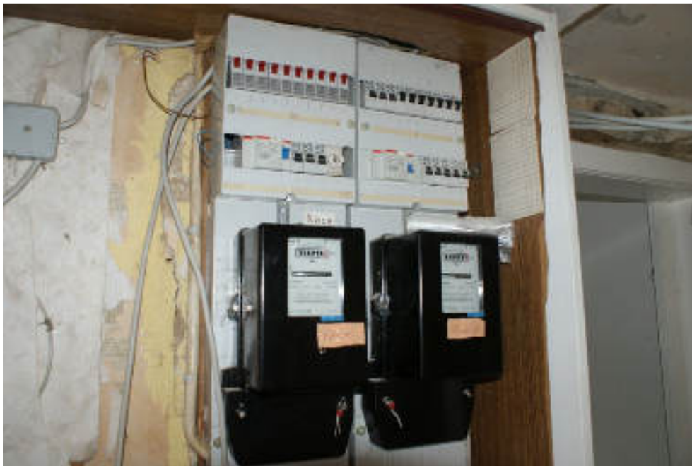
Bild 33 Detail Elektroählerkasten OG/ Versorgung vom Dachreiter
