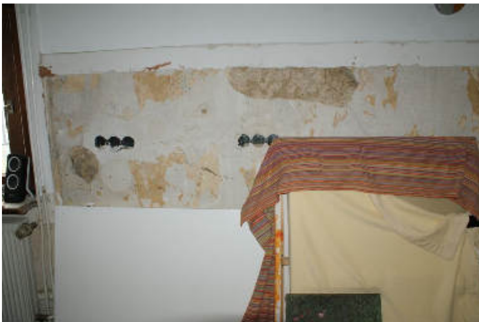
Bild 84 Beispiel für begonnene, unfertige Elektroinstallation
