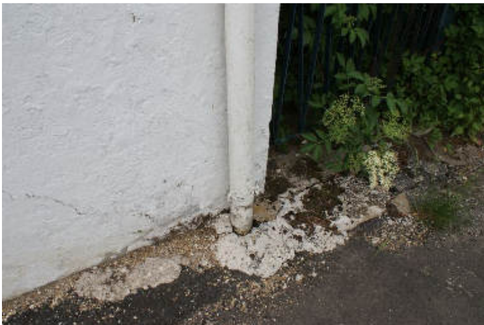
Bild 62 Stark schadhafes Fallrohr und Mauerwerksschäden Südgiebel
