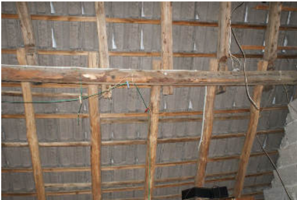
Bild 53 Mangel: ungedämmtes Hauptdach, auch ohne Unterspannbahn
