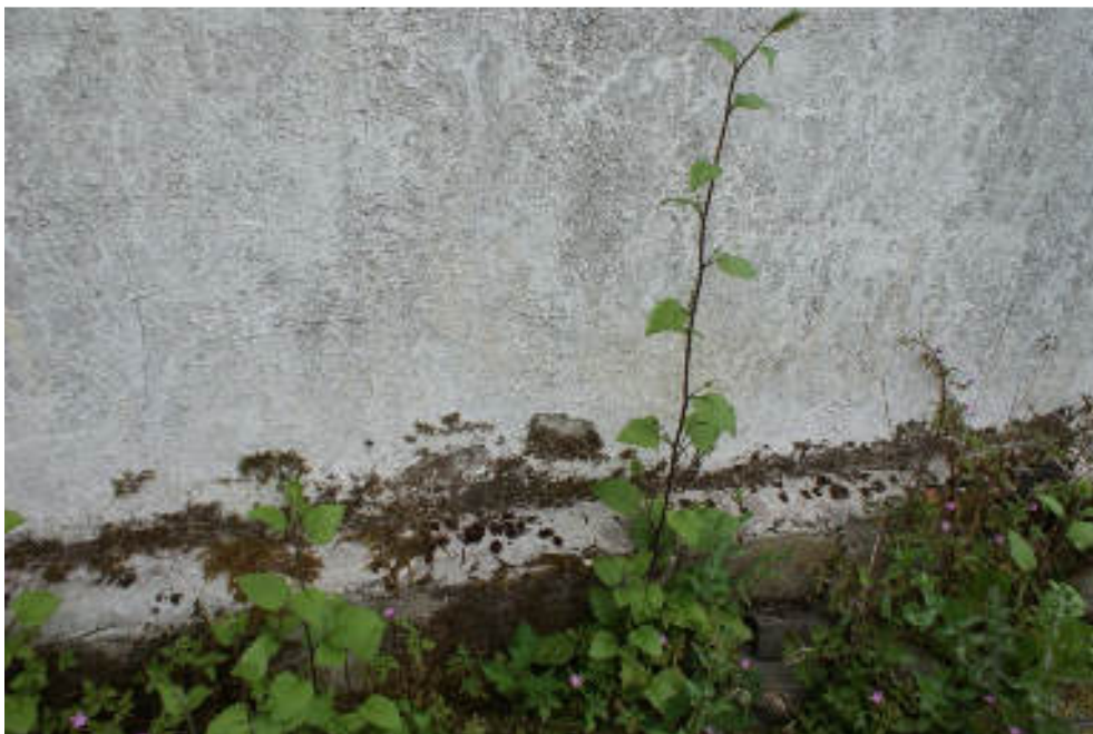
Bild 70 Nässeschäden am Sockel der Garage hinten
