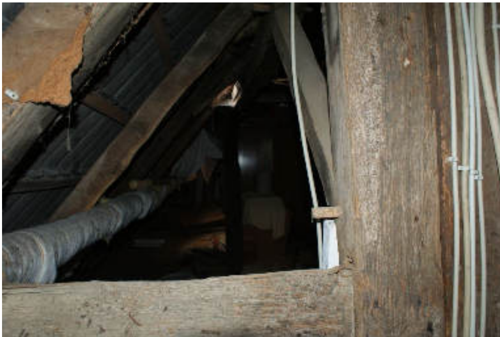
Bild 51 Dachraum Anbau / links Heizungsleitung
