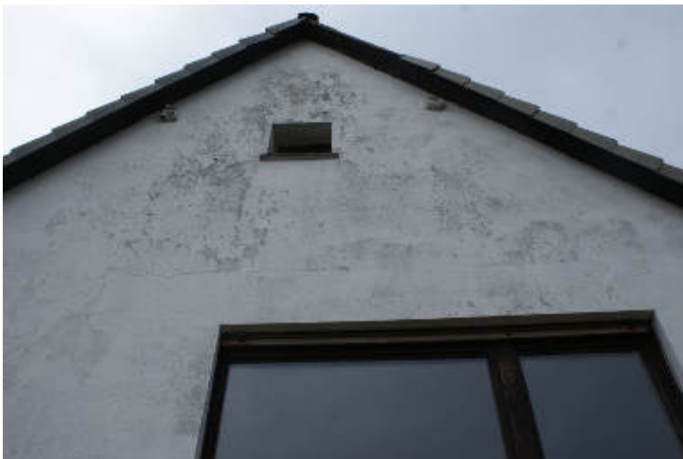
Bild 60 Beispiel für Feuchte- und Putzschäden Südgiebel
