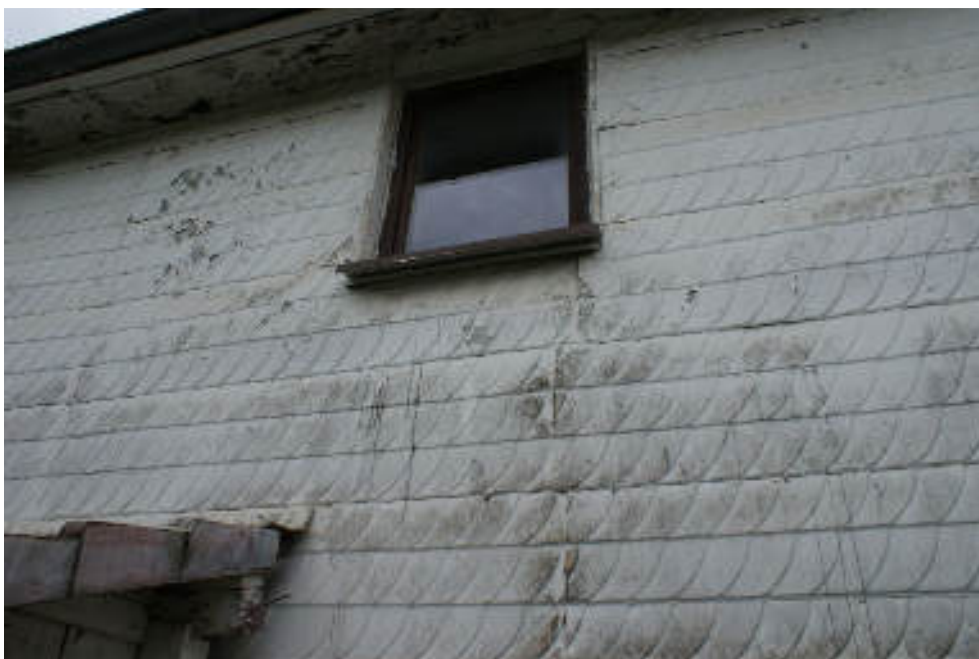
Bild 66 Schadhafte Blechverkleidung am Anbau
