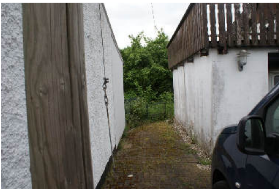
Bild 52 Mangel: nach heutigem Baurecht zu geringer Grenzabstand wegen der Dachterrasse
