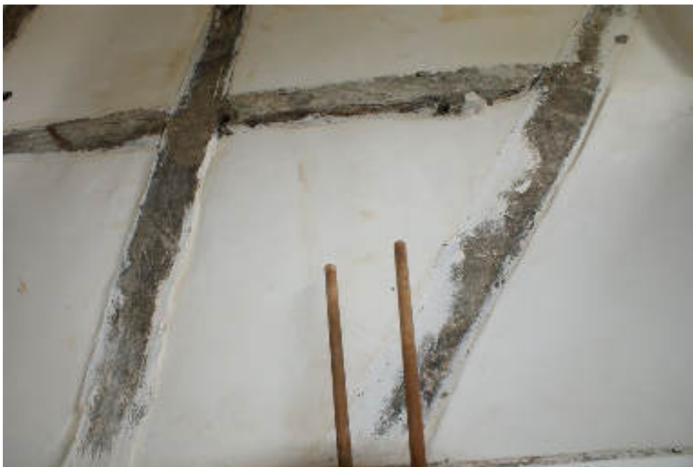
Bild 76 Putzschäden innen am Fachwerk
