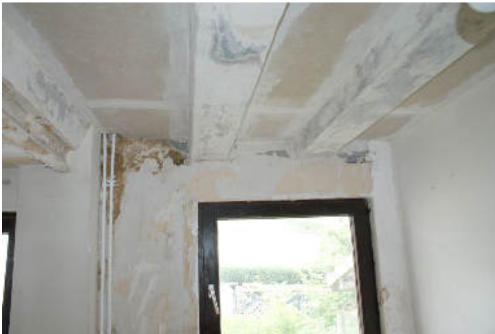
Bild 81 Schäden an Deckenbalken Anbau /Wasserschaden oben
