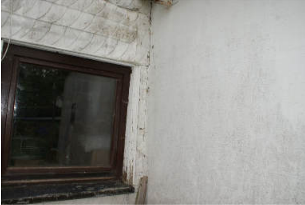
Bild 63 Schäden am Übergang Anbau zu Garage und Holzleibungen
