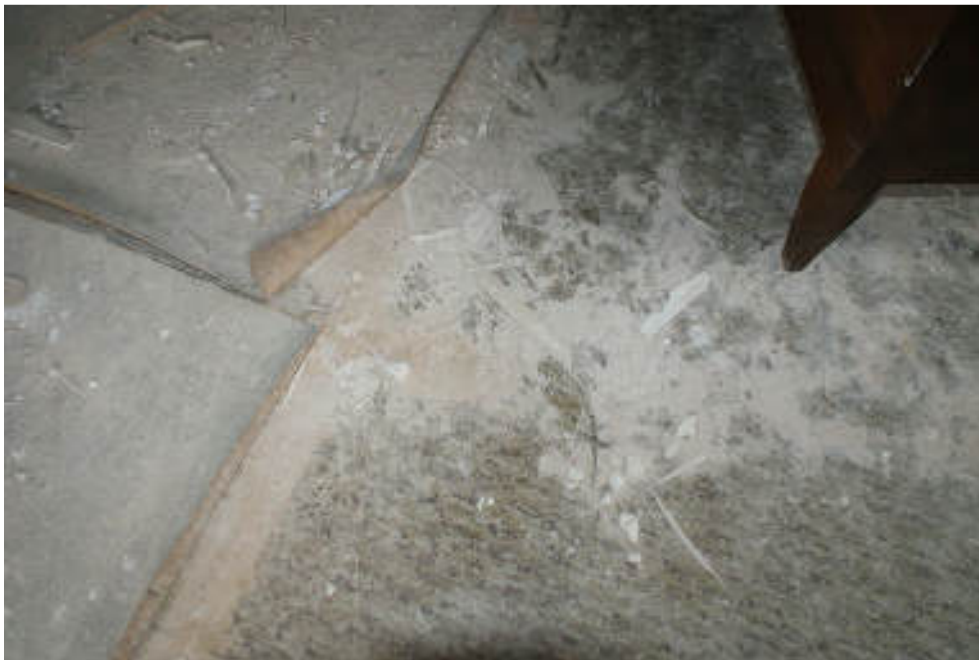
Bild 83 Desolate alte PVC-Böden im OG
