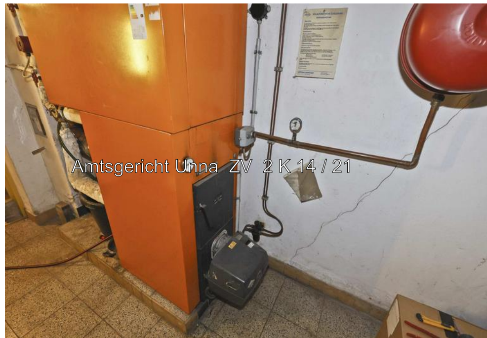
Foto Nr. 4 KG: Heizungskeller
