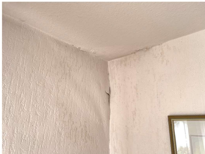
Feuchtigkeitserscheinungen im Erdgeschoss
