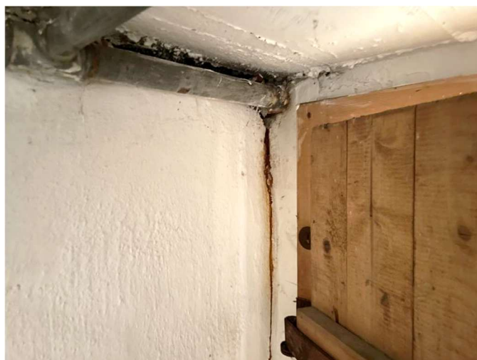
Feuchtigkeitserscheinungen im Kellergeschoss
