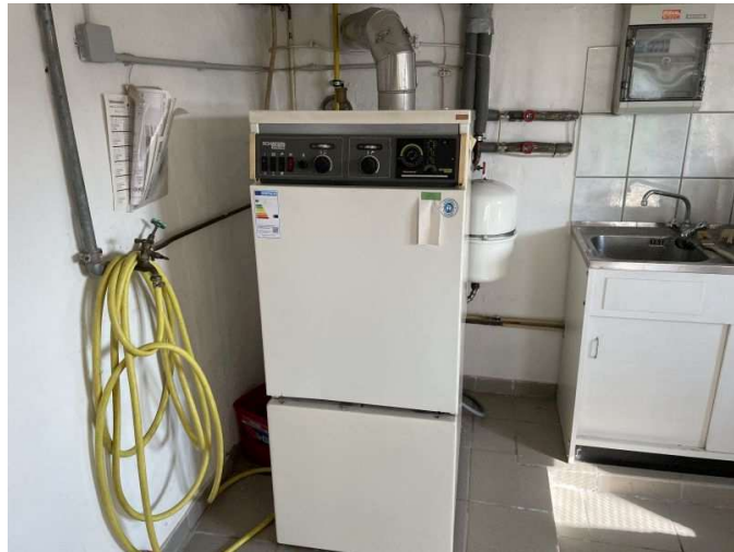
Heizungsanlage im Kellergeschoss
