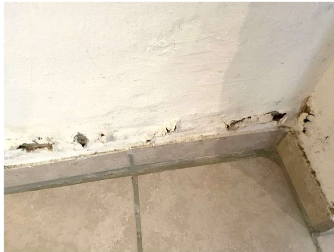
Feuchtigkeitserscheinungen im Kellergeschoss
