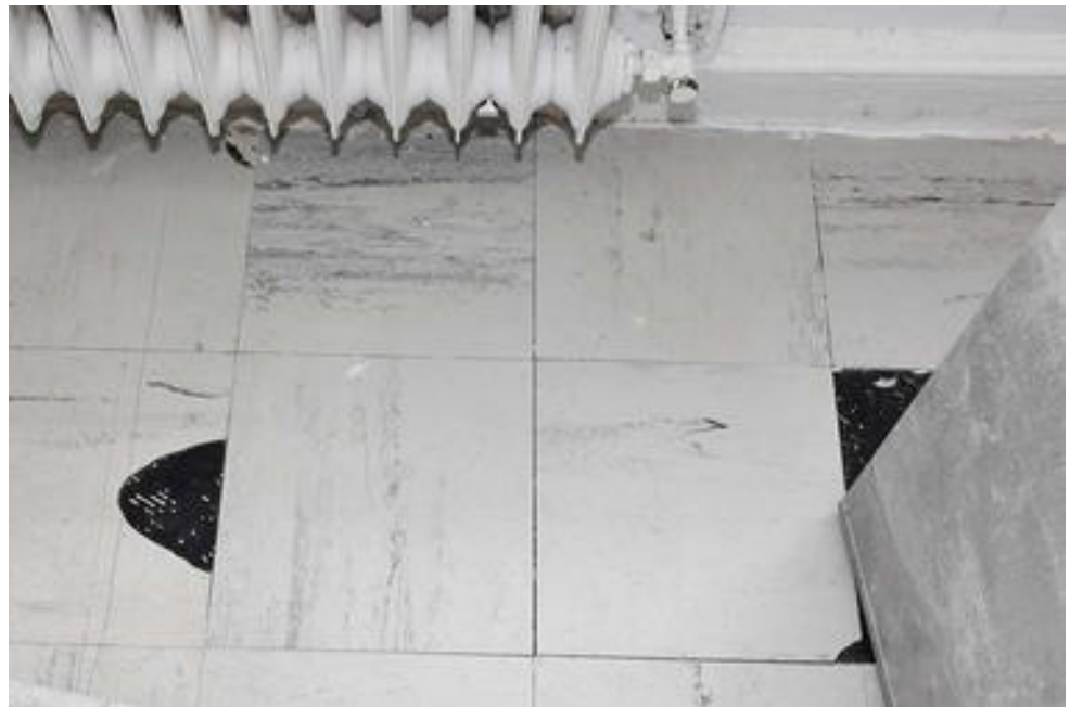
Foto Nr. 13 3.OG We Nr. 17: Detail ausgebrochenem Oberbelag
