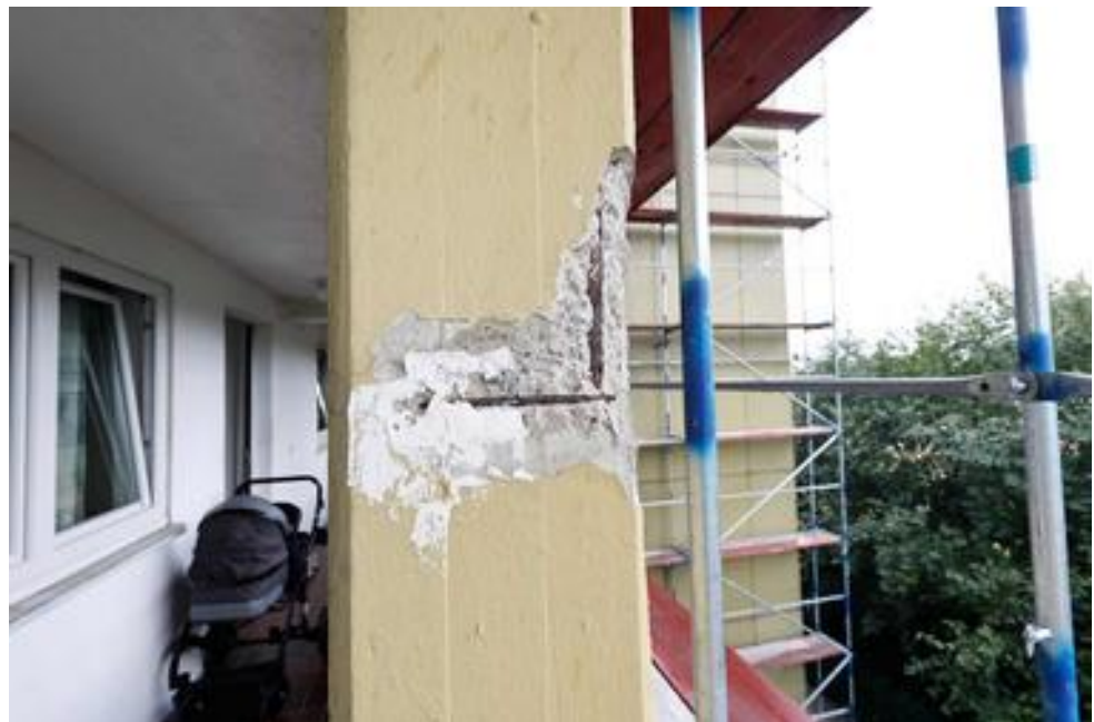
Foto Nr. 8 3.OG: Detail Betonstütze mit Carbonatisierungsschäden
