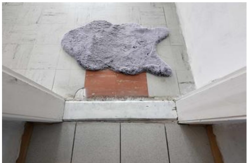
Foto Nr. 12 3.OG We Nr. 17: Detail Türschwelle mit defektem Bodenbelag
