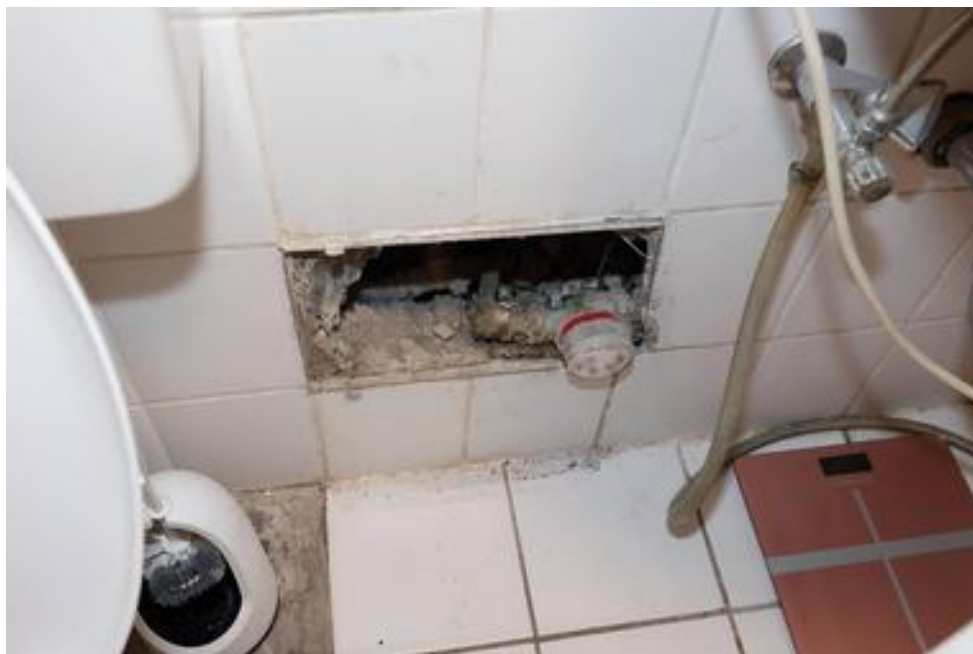
Foto Nr. 15 3.OG We Nr. 17: Bad Detail unverschlossene Wandöffnung
