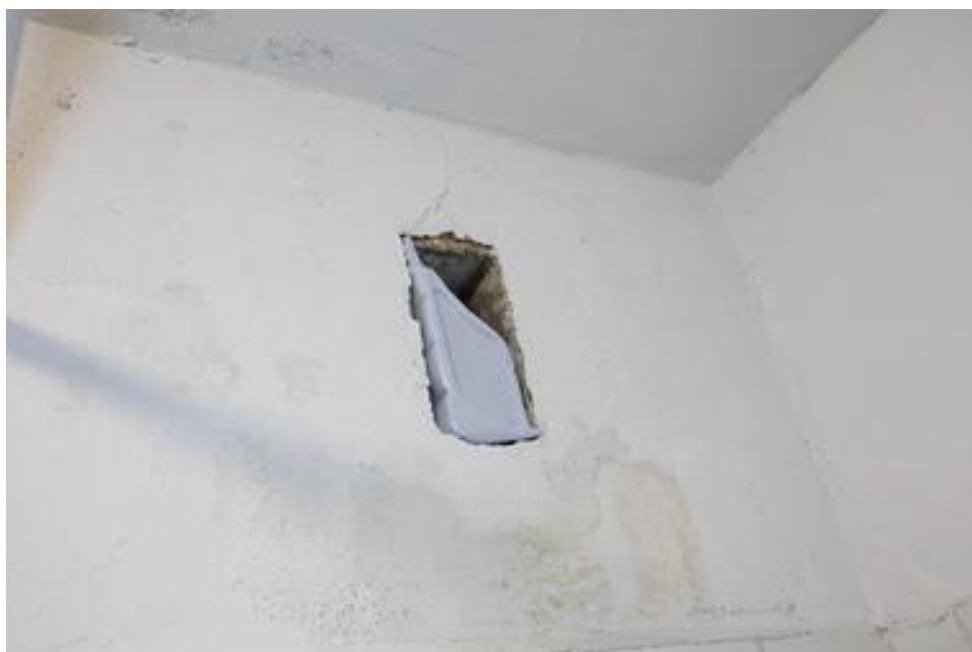
Foto Nr. 16 3.OG We Nr. 17: Bad Detail Lüftungsöffnung und Wandoberfläche
