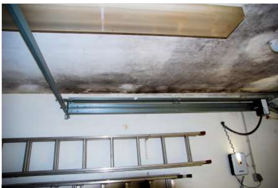
Foto 54 Ritterseifener Weg 30, Feuchtigkeit in der Garage
