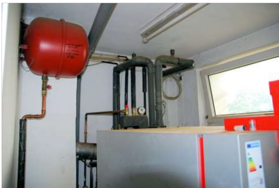
Foto 53 Ritterseifener Weg 30, Heizungsraum hinter der Garage
