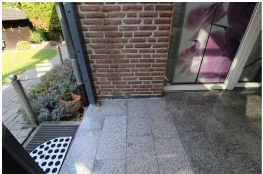
Außenwand am Schlafzimmer feucht
