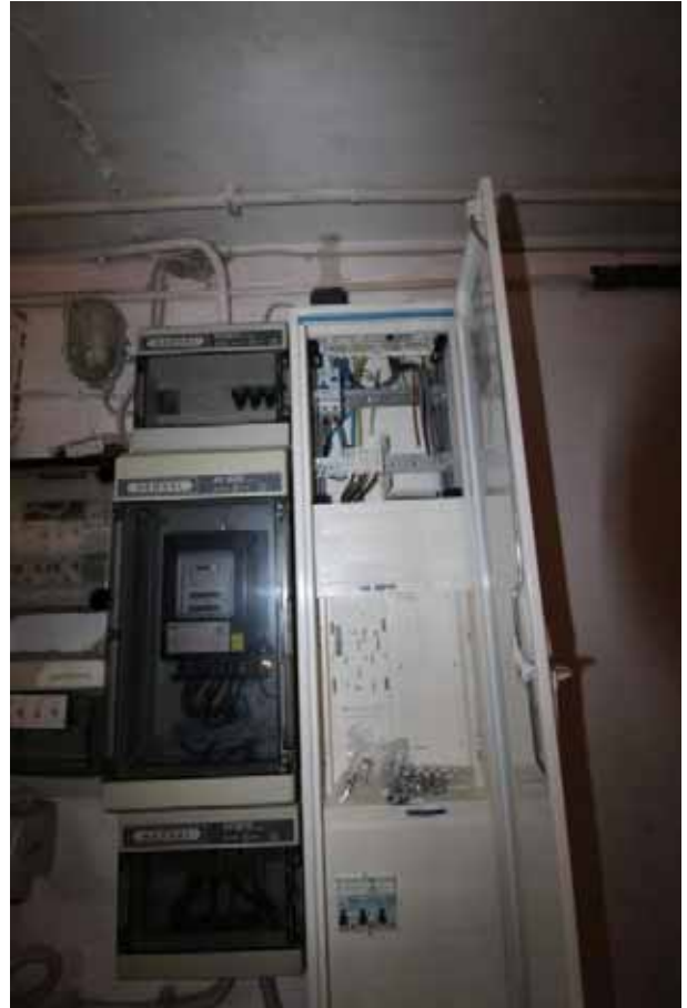
Leerer Zählerkasten der Photovoltaikanlage
