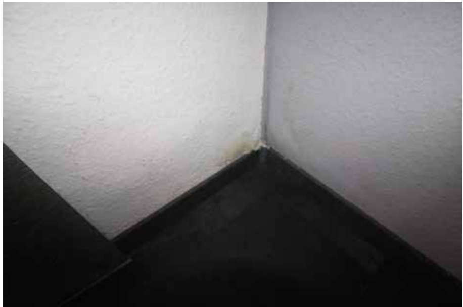
Feuchtigkeitsflecken an Außenwand im Schlafzimmer rechts des Fensters
