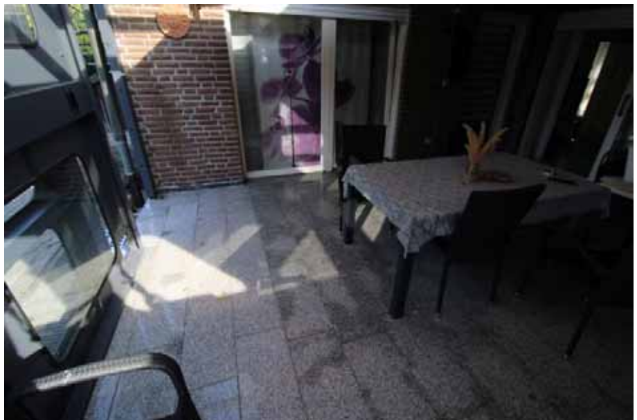
Bodenfliesen im Win- tergarten feucht
