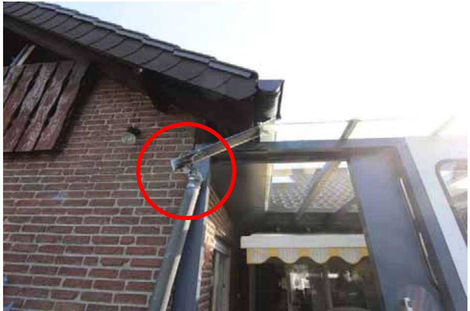
Dachentwässerung am Anschluss Winter- garten/Gebäude de- fekt
