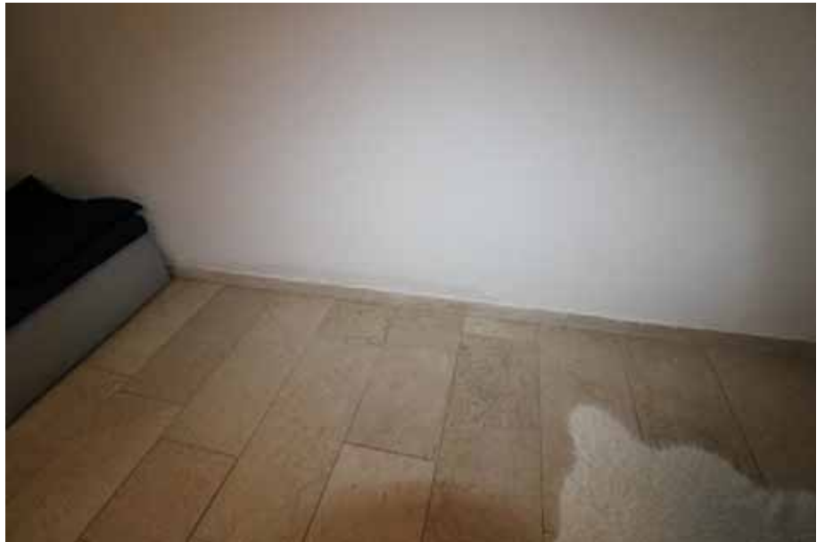
Feuchtigkeitsflecken an der Kelleraußen- wand unterhalb des Küchen-Essbereichs
