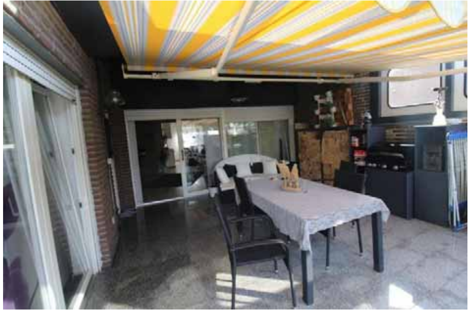
Bodenfliesen im Wintergarten feucht
