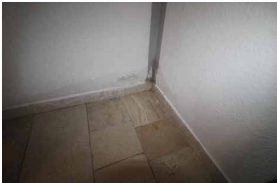
Feuchtigkeitsflecken an der Kelleraußen- eckewand unterhalb des Küchen- Essbereichs
