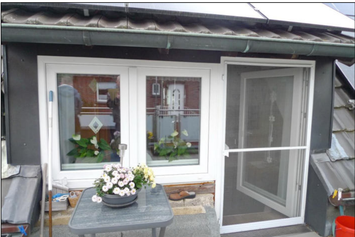
Abbildung 33 geringe Türhöhe zur Dachterrasse vom Zweifamilienhaus auf dem zu bewertenden Grundstück fotografiert am 31.10.2023
