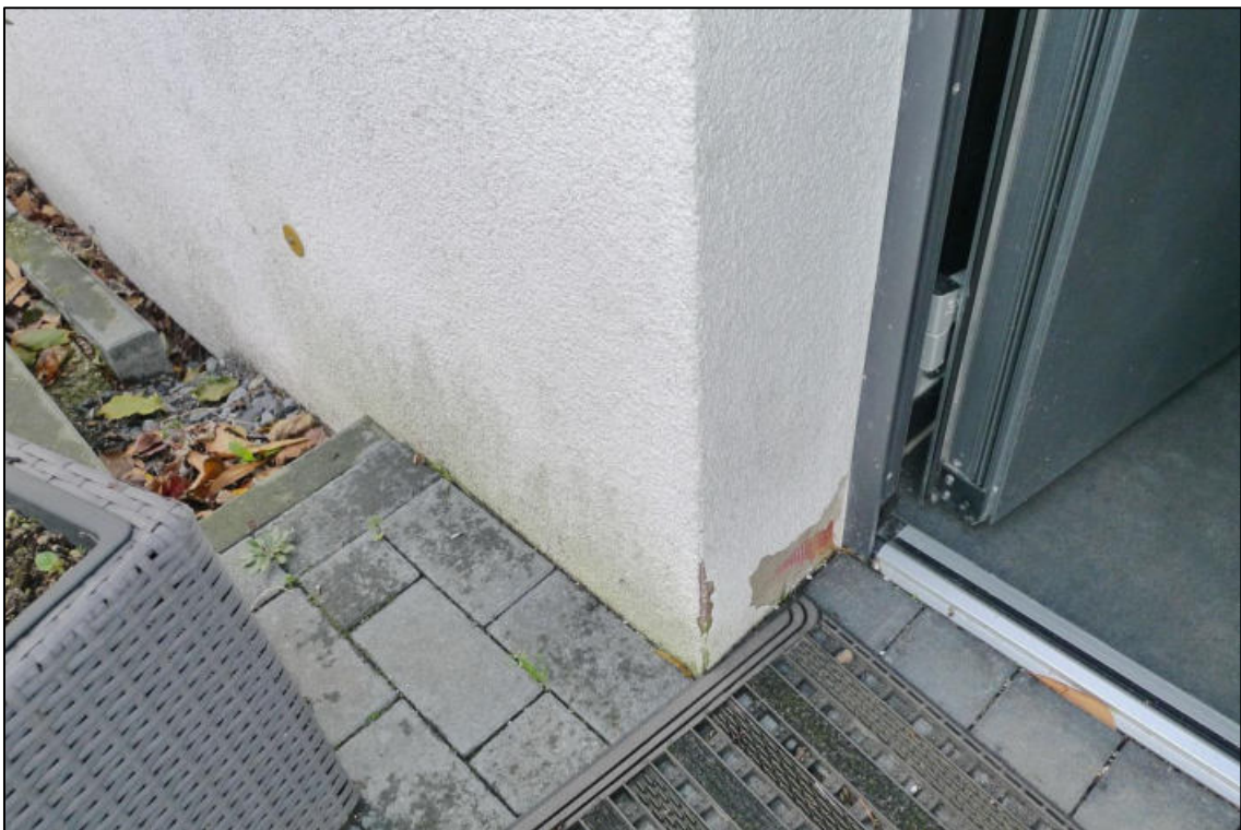
Abbildung 35 Beschädigungen am Putz am Eingangsbereich vom Zweifamilienhaus auf dem zu bewertenden Grundstück fotografiert am 31.10.2023
