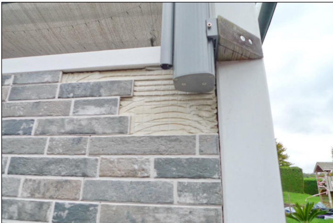
Abbildung 31 fehlende Klinkerriemchen an der Fassade vom Zweifamilienhaus auf dem zu bewertenden Grundstück fotografiert am 31.10.2023
