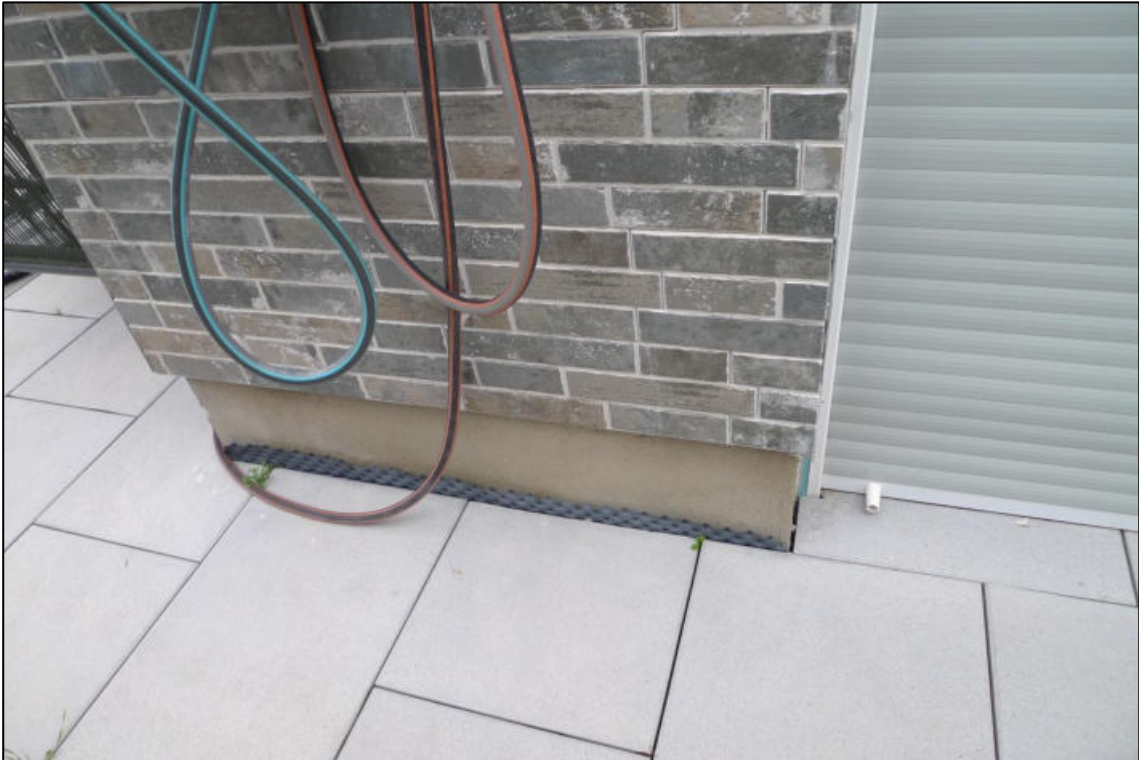
Abbildung 32 fehlende Klinkerriemchen an der Fassade vom Zweifamilienhaus auf dem zu bewertenden Grundstück fotografiert am 31.10.2023
