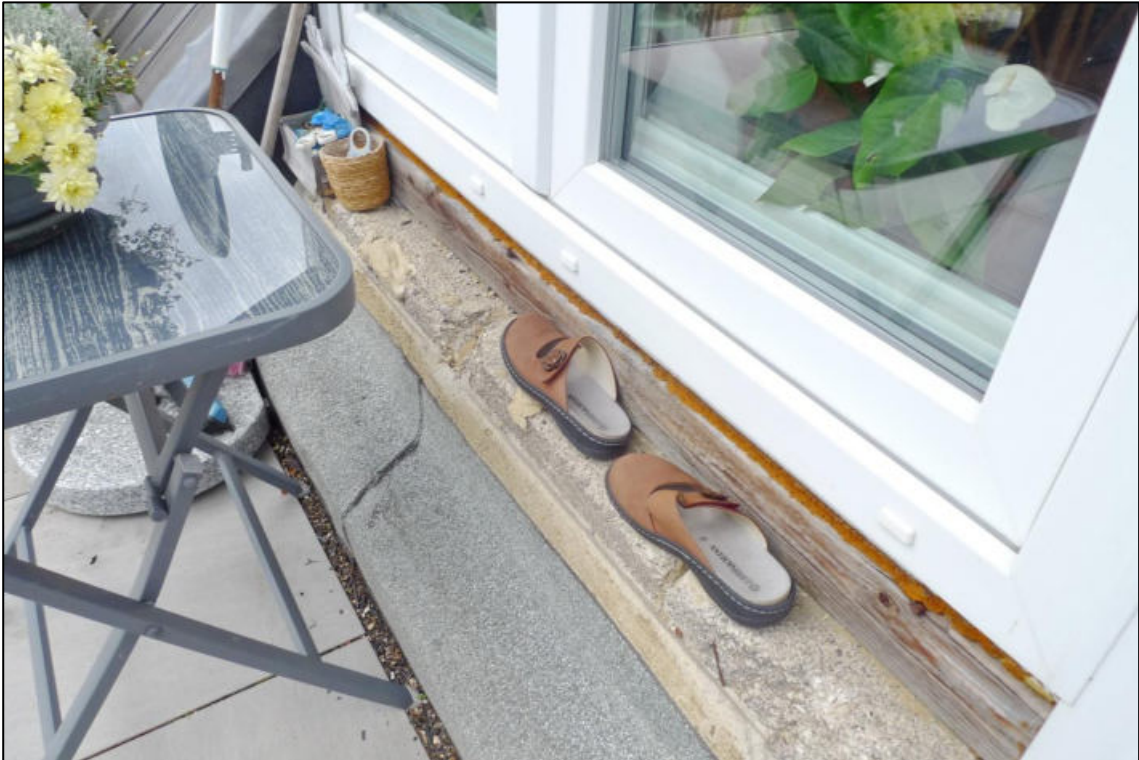
Abbildung 34 fehlende Fensterbank am Dachgaubenfenster zur Dachterrasse vom Zweifamilienhaus auf dem zu bewertenden Grundstück fotografiert am 31.10.2023
