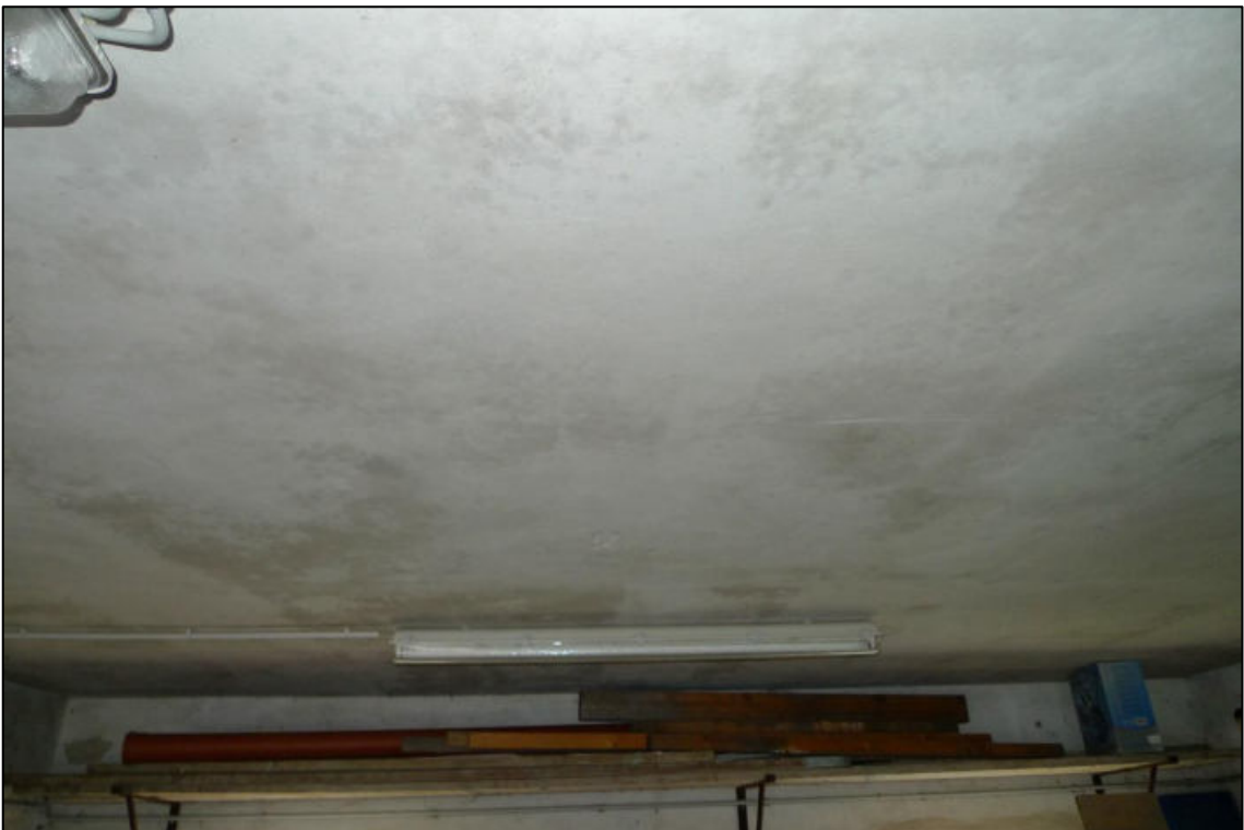
Abbildung 39 Feuchtigkeitsflecken an der Decke der Doppelgarage auf dem zu bewertenden Grundstück, fotografiert am 31.10.2023
