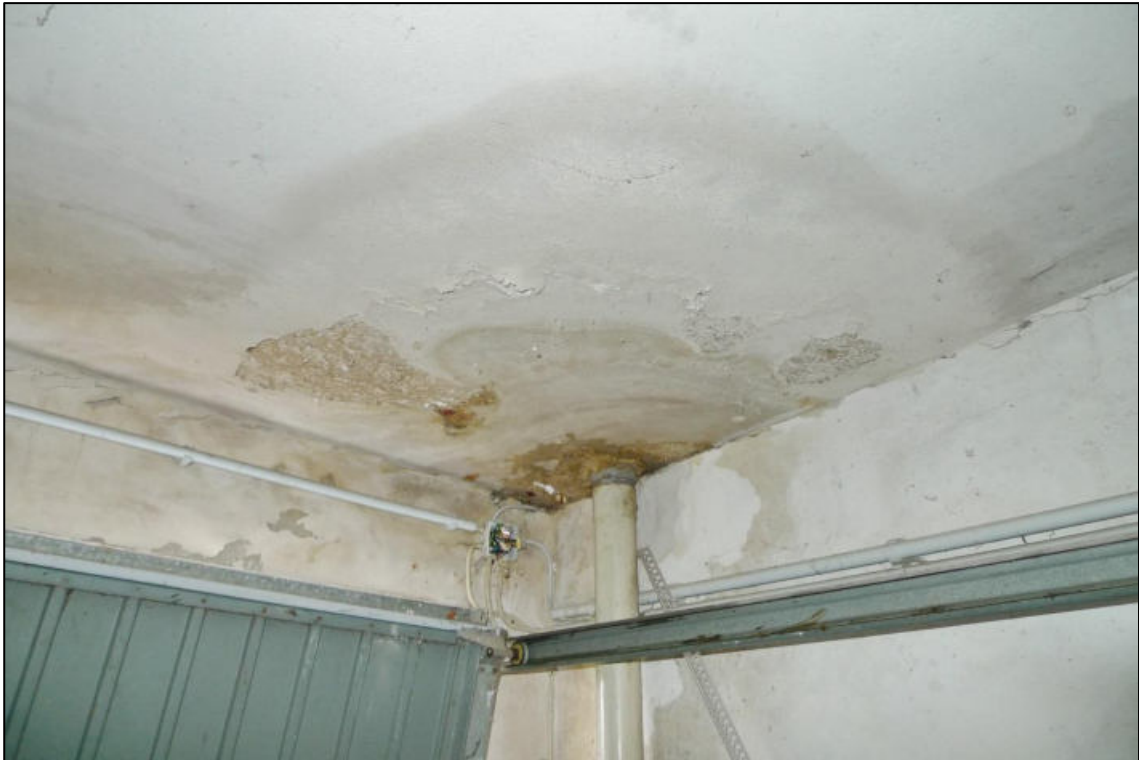
Abbildung 38 Feuchtigkeitsflecken an der Decke der Doppelgarage auf dem zu bewertenden Grundstück, fotografiert am 31.10.2023
