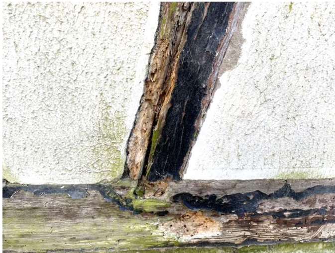
Schäden im Holzfachwerk
