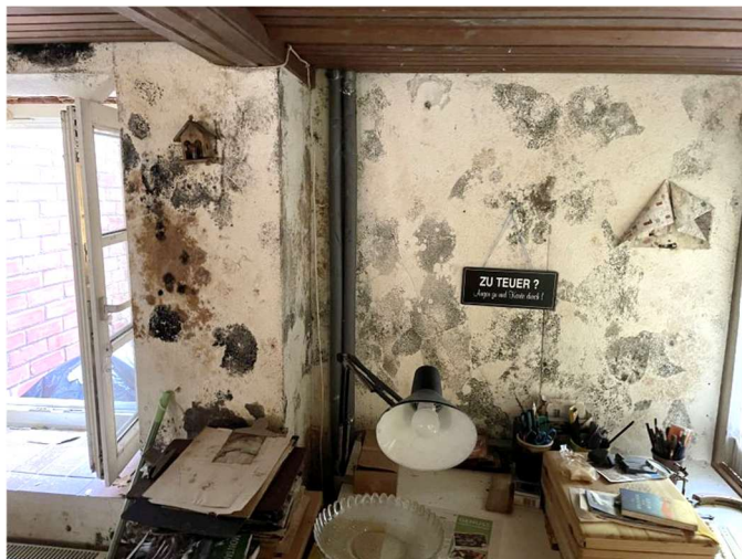
Schäden im Erdgeschoss
