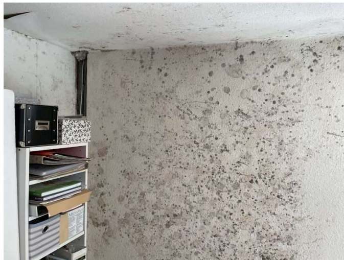
Schäden im Obergeschoss
