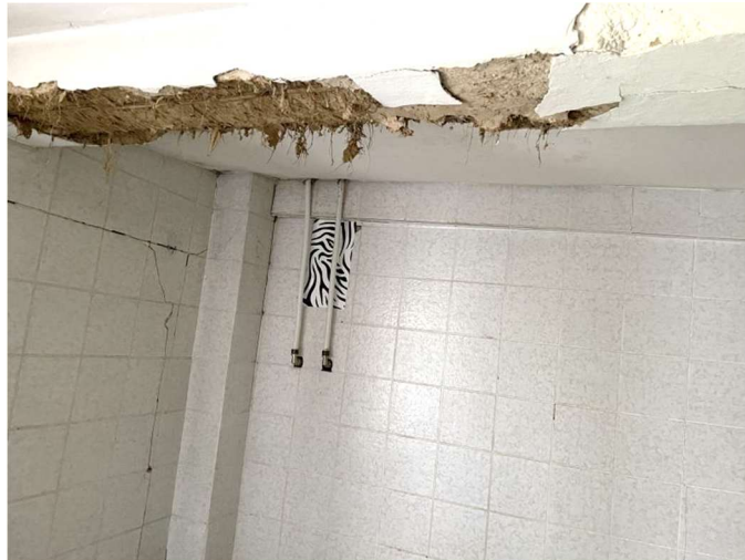
Schäden im Obergeschoss
