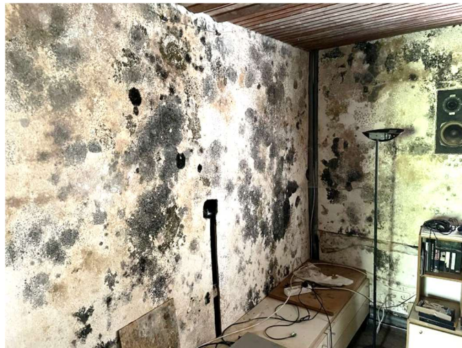
Schäden im Erdgeschoss
