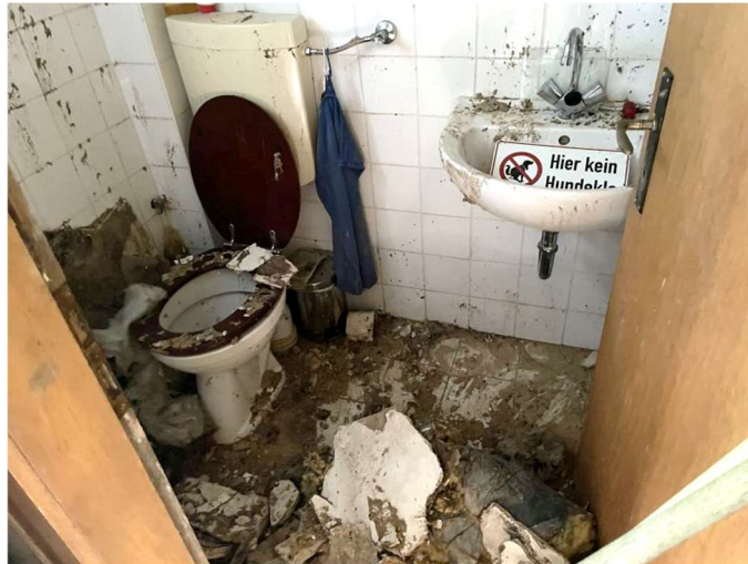
Schäden im Erdgeschoss
