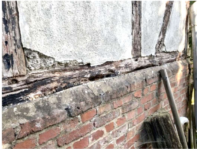
Schäden im Holzfachwerk
