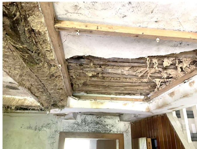
Schäden im Erdgeschoss
