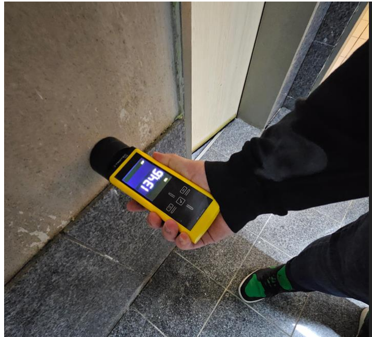
Abbildung 6 - Messung Wandfuss, 134 Digits = hohe Feuchtigkeit
