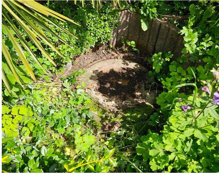
Abbildung 20 - zugewachsener Deckel des Revisionschachtes
