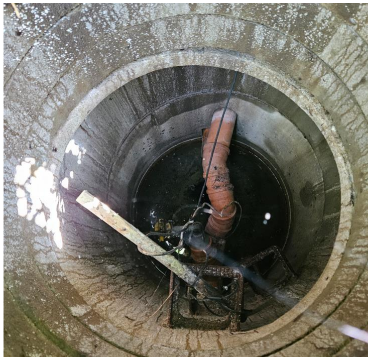
Abbildung 21 - Blick in den Revisionschacht
