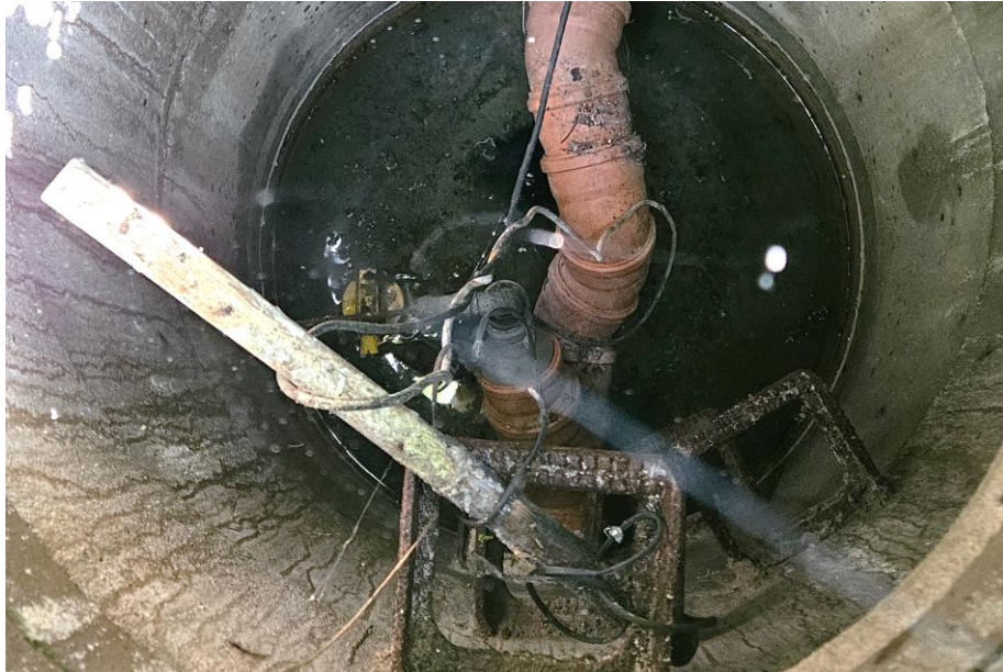
Abbildung 22 - keine ordnungsgemäße Situation hier besteht Wartungsstau
