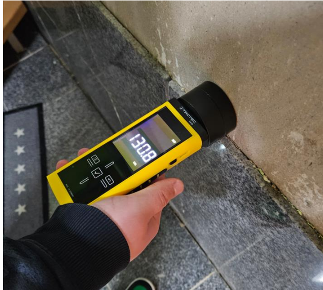
Abbildung 7 - Messung über dem Fliesensockel auf ca. 1,50 m Höhe, 130 Digits = hohe Feuchtigkeit
