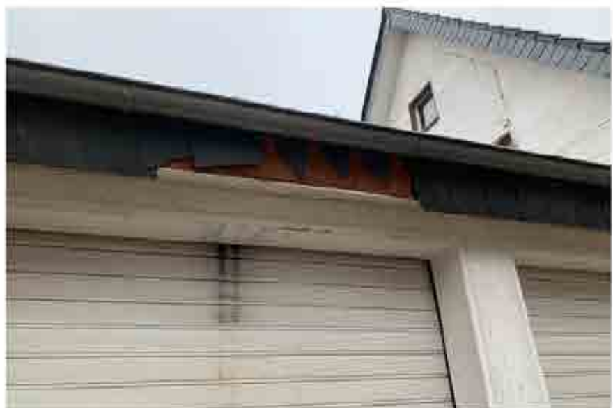
Detail Garage, Schaden an der Dachrandverkleidung
