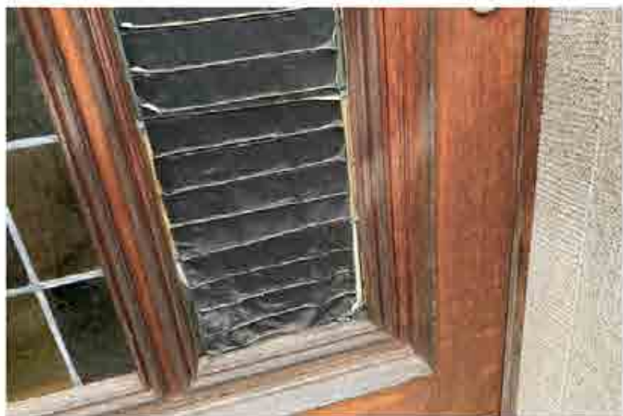
Hauseingangstür, Schäden an der Türverglasung
