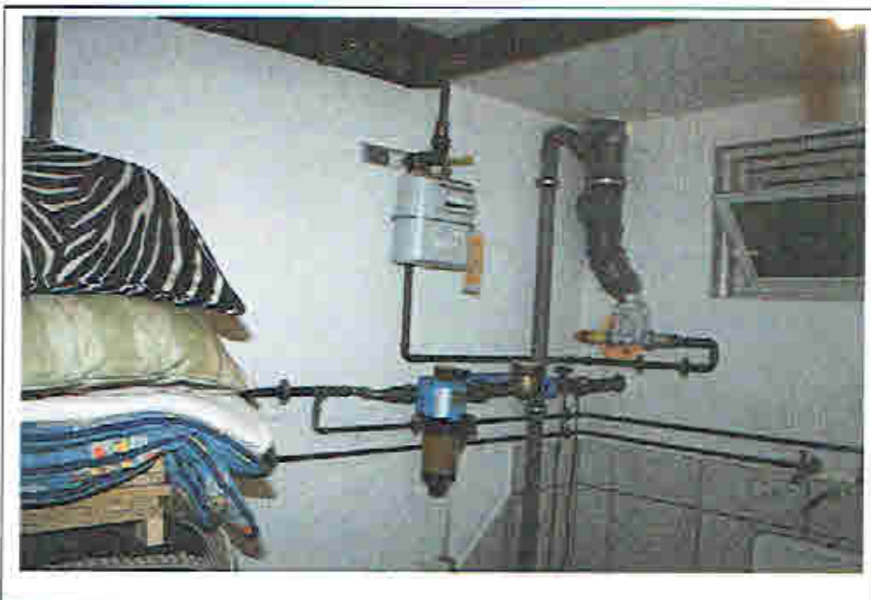
11 Gasanschluss, Gaszähler, Wasserhausanschluss
