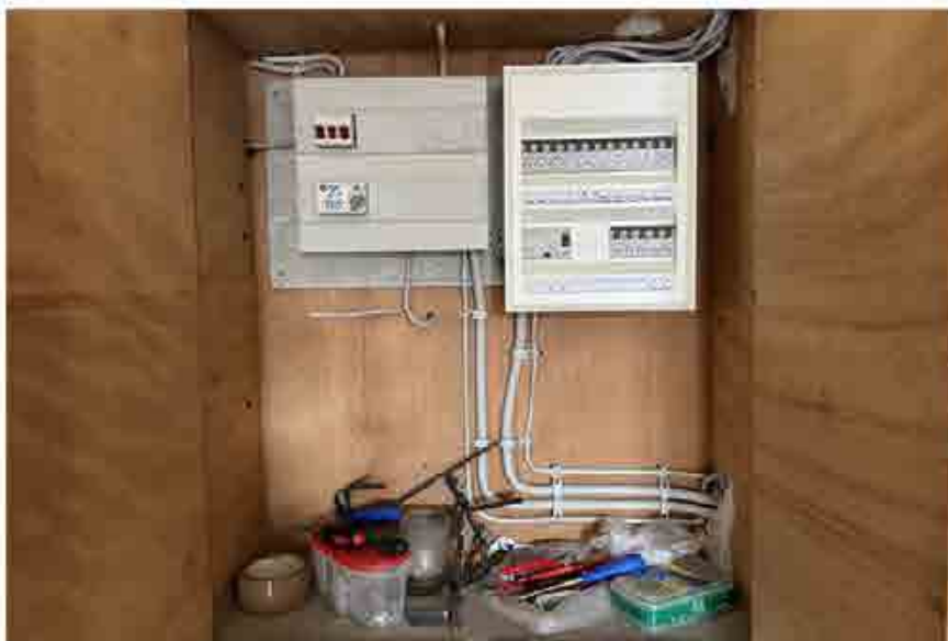
Vogelsangstraße 4, Treppenhaus 2.OG, Sicherungskasten
