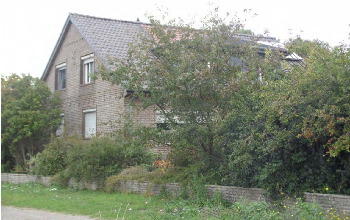
Bild 03: Blick über die westliche Grundstücksgrenze („Mauer“) des Bewertungflurstücks 2/3 auf die westliche Giebelseite und die sich rechts anschließende („verdeckte“) südliche Traufseite des Wohnhauses mit zwei Wohneinheiten . Oben rechts sind die Solarpaneele zu erkennen.
