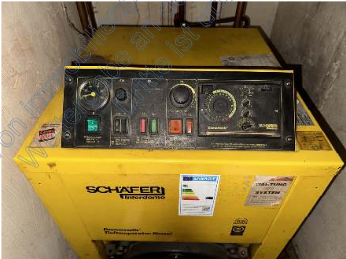
Bild 18: Ausschnitt – völlig überalterte Heizungsanlage (Wohnhaus EG).
