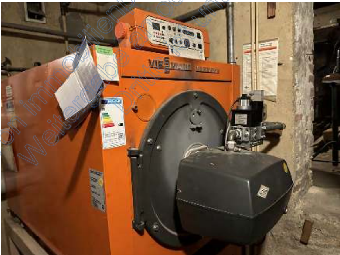
Bild 38: Ausschnitt – Heizungsanlage im Kellerraum 2 (Wohn- und Geschäftshaus KG).
