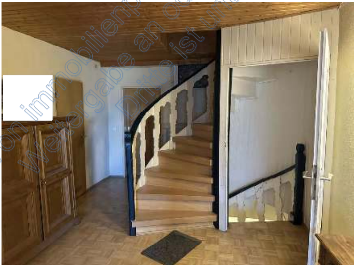
Bild 48: Ausschnitt – Diele Richtung Treppe zum Dachgeschoss bzw. zur Wohnung Nr. 3 ( Wohn- und Geschäftshaus OG).
