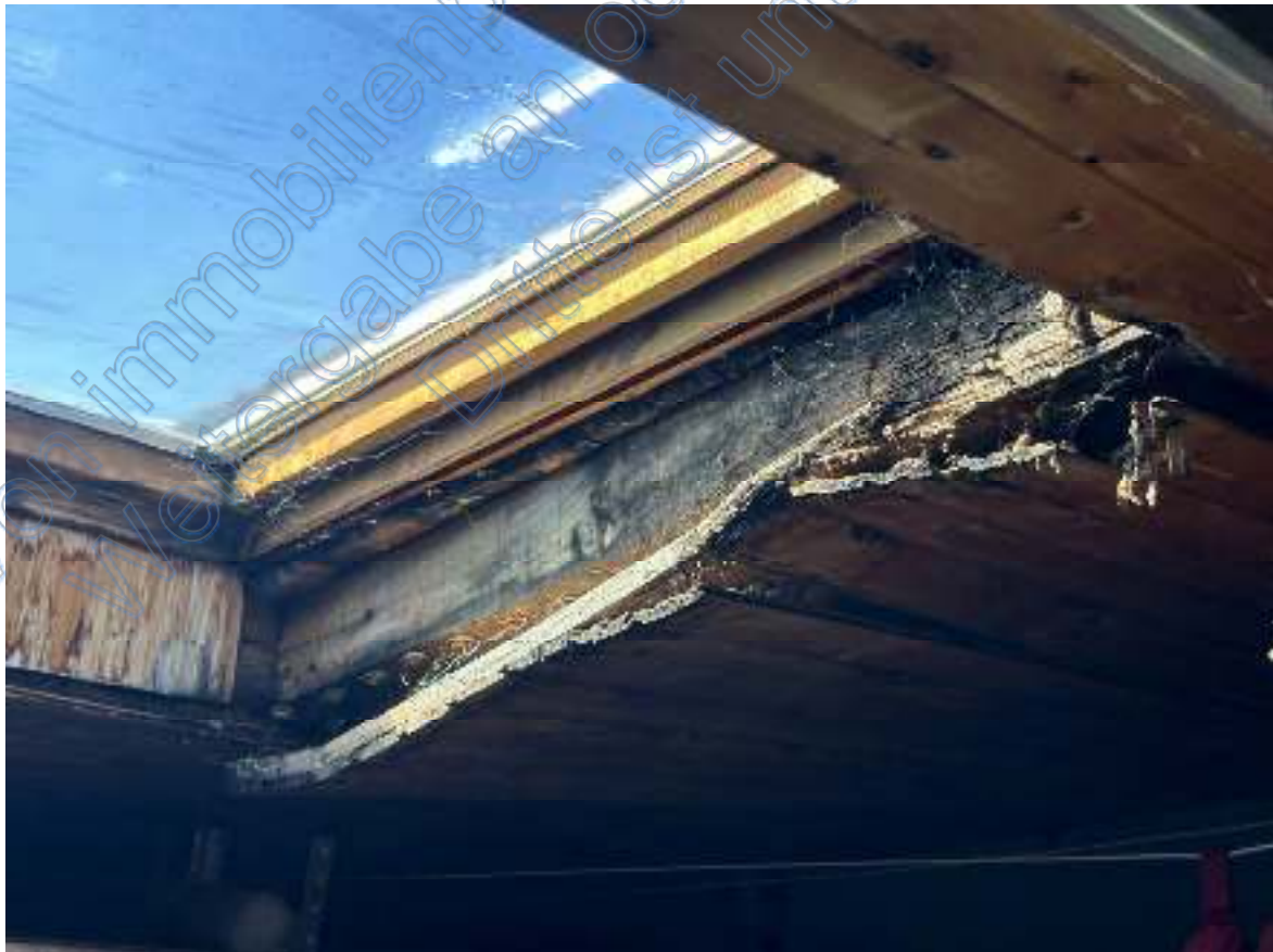
Bild 26: Ausschnitt – extreme Feuchtigkeitsschäden am Dachflächenfenster im Lagerraum I (Konditoreianbau Gastronomieeinheit OG).
