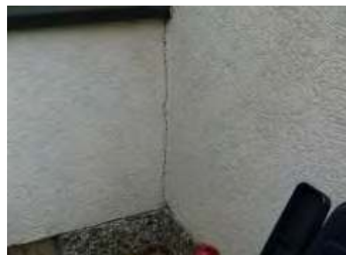
Rissbildung im Eck-Anschlussbereich
