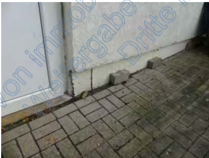
Sockel nicht fertiggestellt, kein fachgerechter An- und Abschluss
