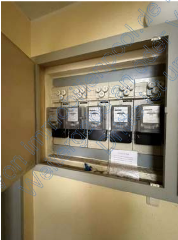
Elektrosicherungen und Zähler im Gemeinschaftsflur Hausnummer 54
