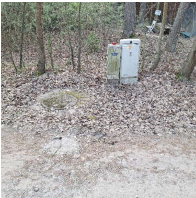
Abbildung 12: Abwasser- und Stromanschlüsse sind vorhanden
