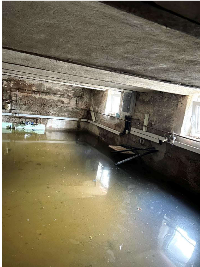
Foto 19: Stallgebäude, Innenaufnahme Teilkeller (überflutet) aufgenommen am 07.03.2024
