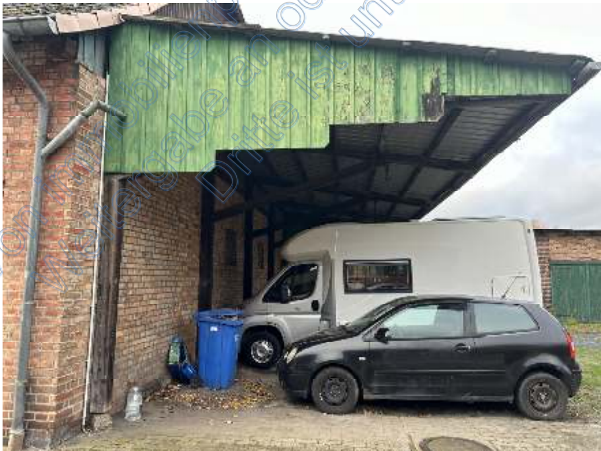
Bild 06: Blick über / durch die Ostseite der Überdachung und entlang der nördlichen Giebelseite des Wohnhauses .
