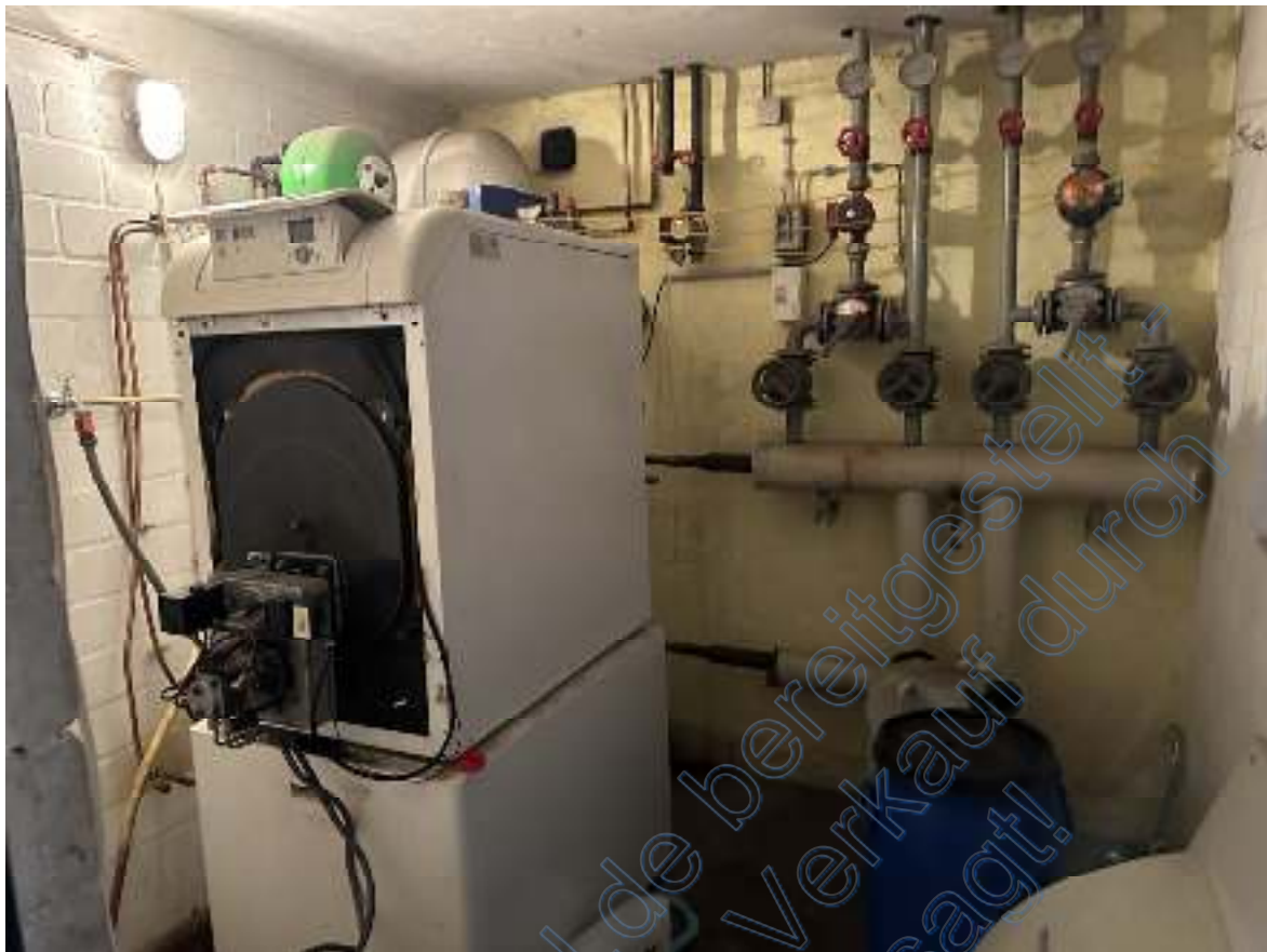
Bild 41: Ausschnitt – Heizungsraum (Lagergebäude EG).
