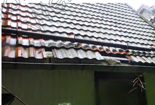
Schäden im Dachbereich (Nordseite)
