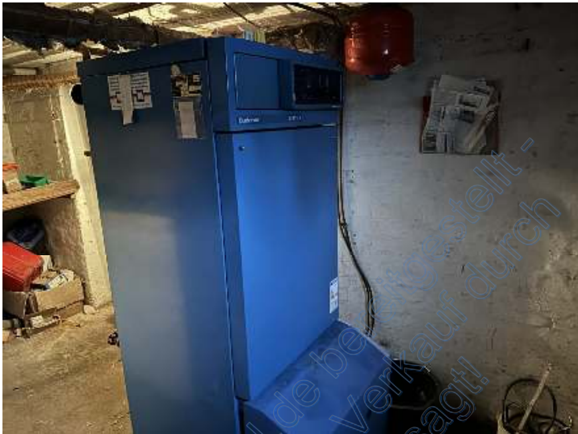
Bild 23: Ausschnitt – Heizkessel im Heizungs- & Öllageraum ( Wohnhaus KG ).
