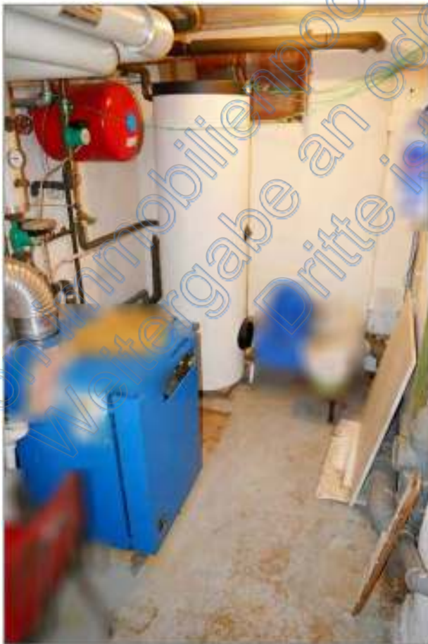
Foto 8 - Wohnhaus - Heizraum KG
