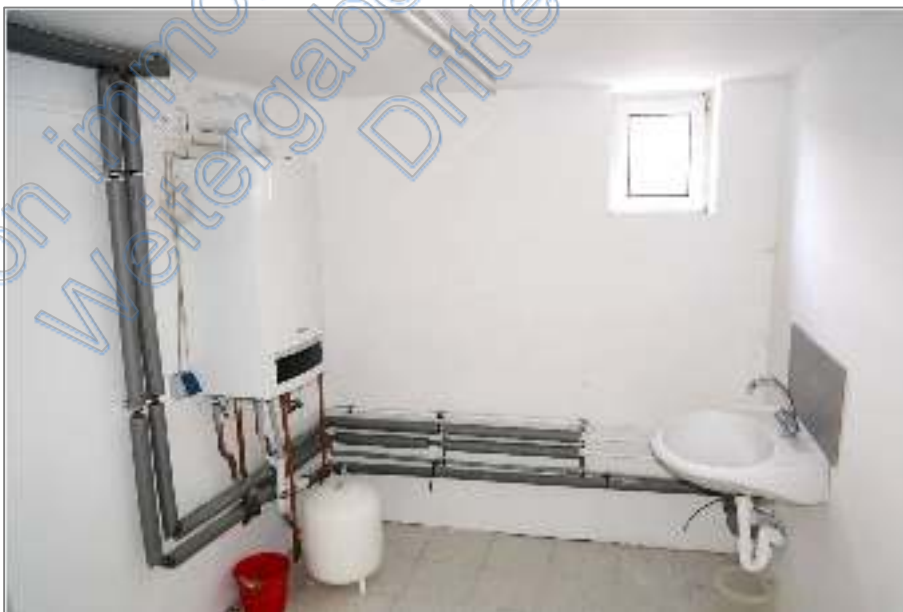
Foto 6 - Wohnhaus - Heizraum KG
