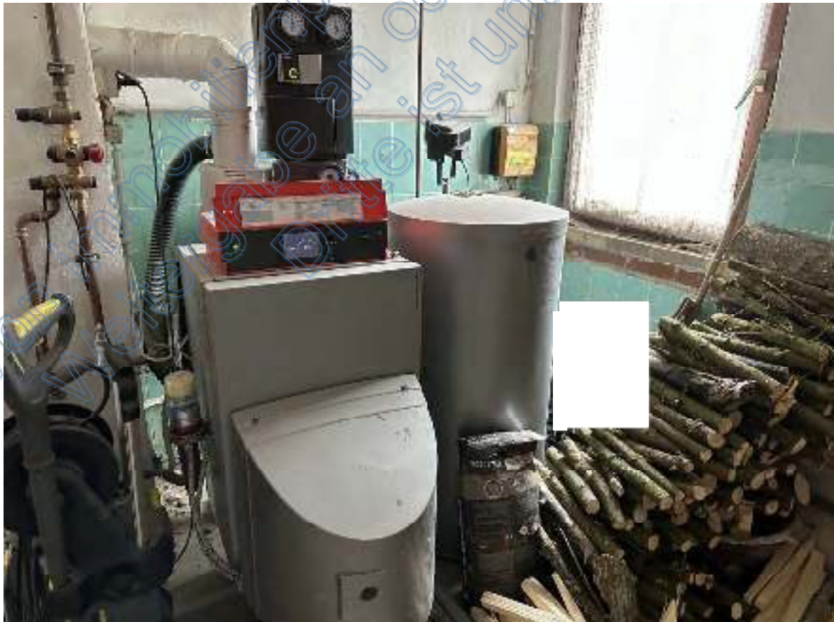
Bild 20: Ausschnitt – Heizungsanlage (Lagergebäude EG).
