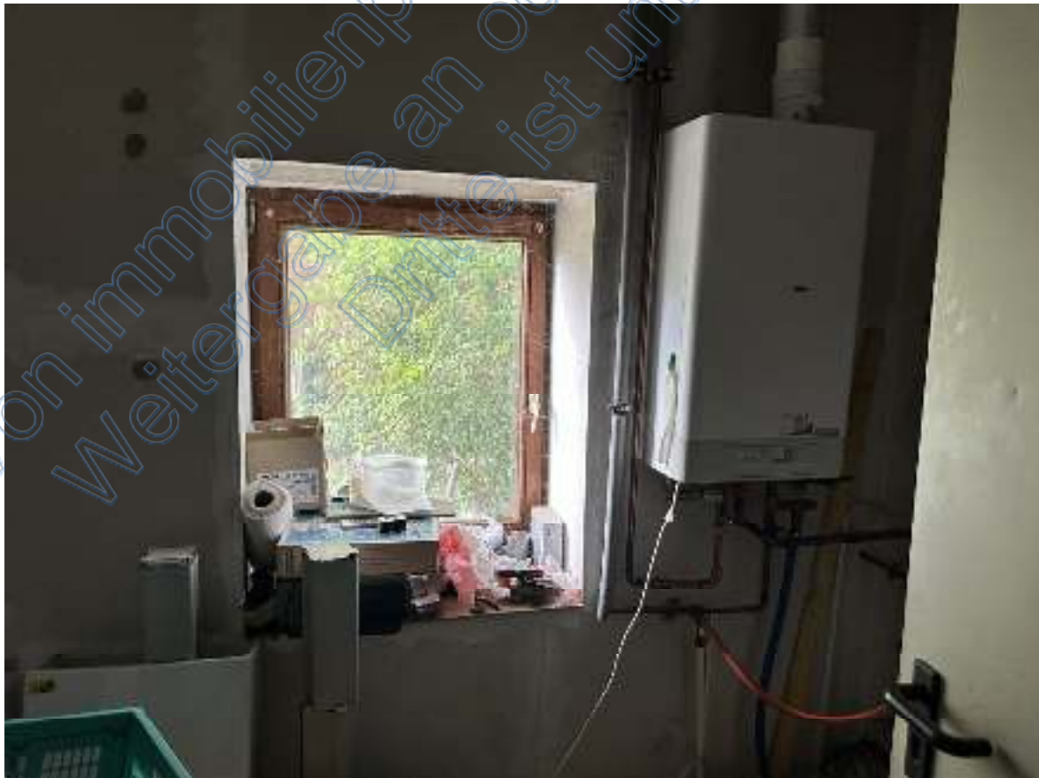
Bild 60: Ausschnitt – Heizungsraum mit Therme (Wohnhaus II mit zwei Wohneinheiten Wohnung 4 EG ).
