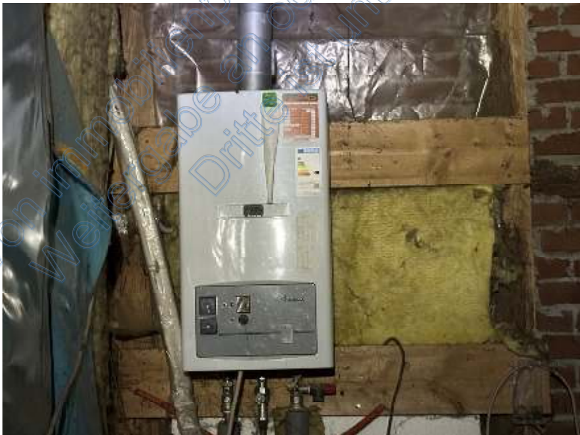
Bild 48: Ausschnitt – Therme im nordöstlichen Dachbodenbereich (Wohnhaus I mit drei Wohneinheiten DG).
