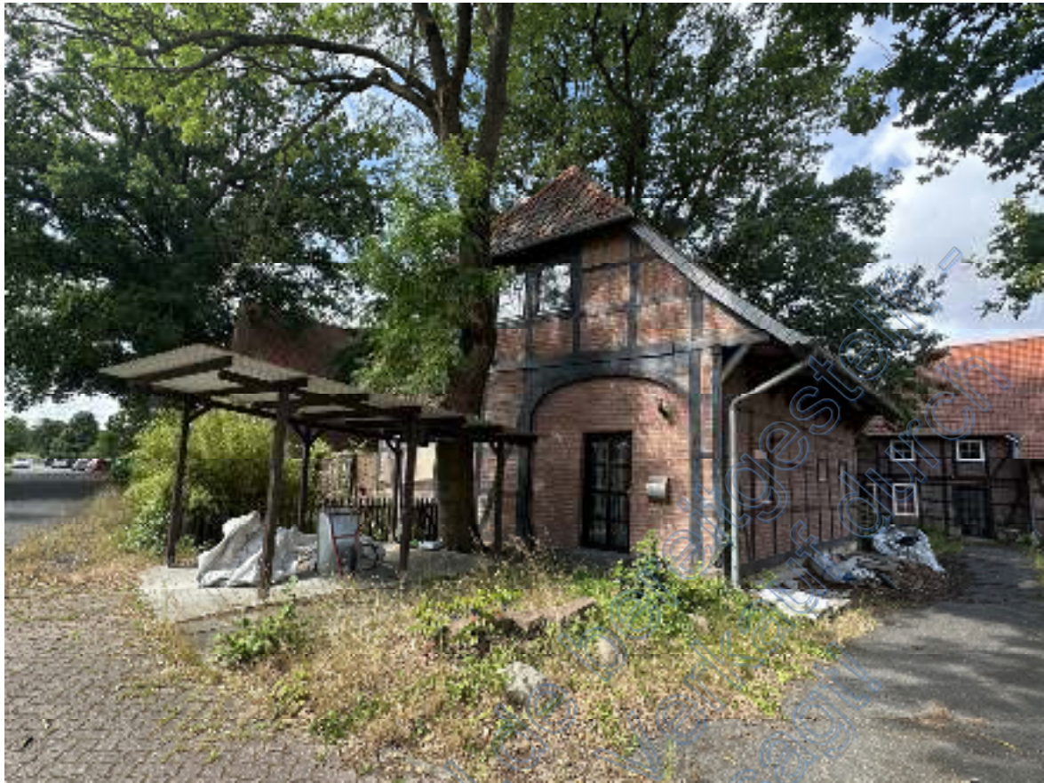
Bild 51: Blick auf die Ostseite (mit geschlossener Hauseingangstür) und die sich rechts anschließende Nordseite des Wohnhauses II mit zwei Wohneinheiten.
