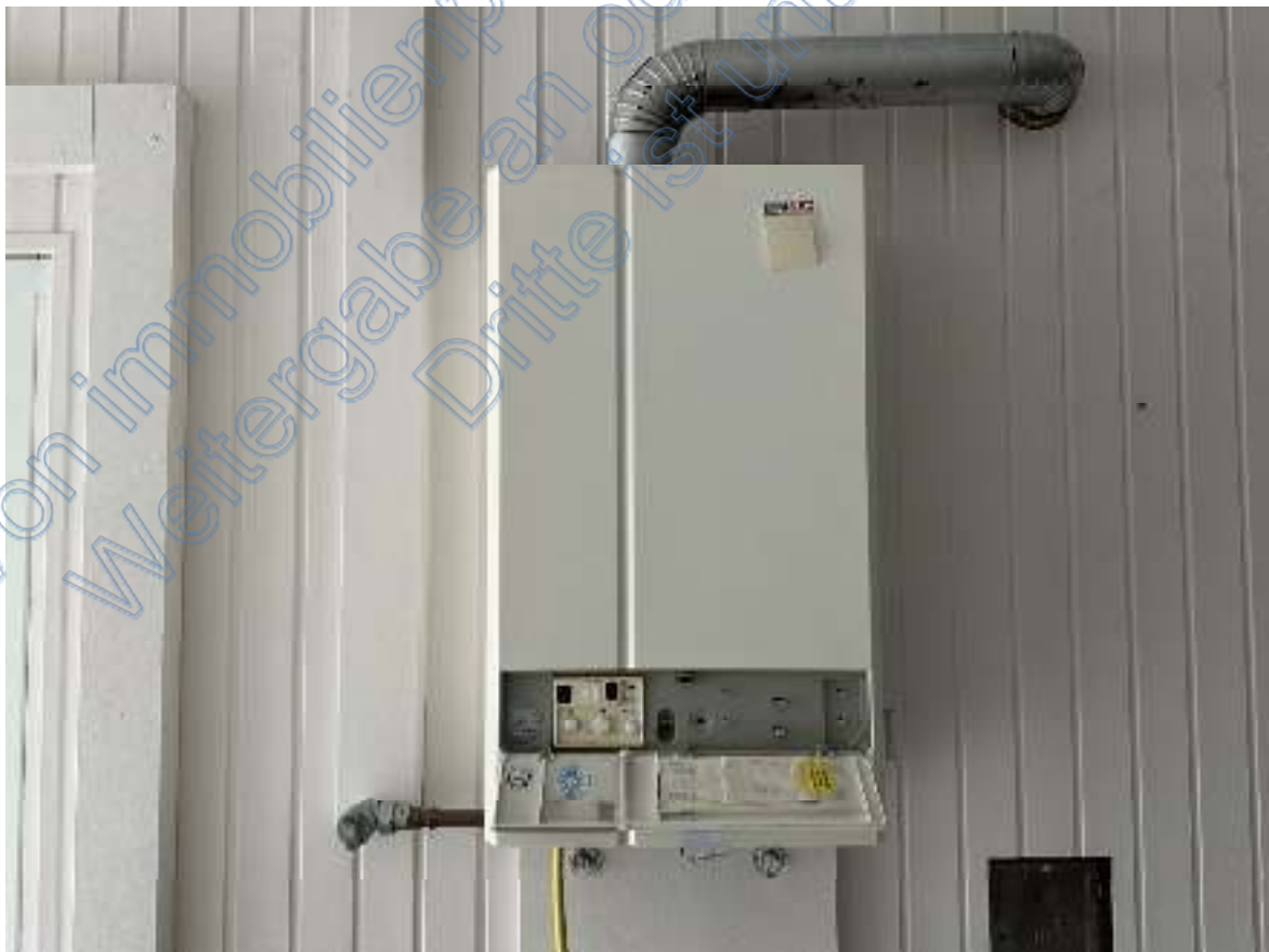
Bild 71: Ausschnitt – Therme im Flur (Wohn- & Bürogebäude Erdgeschosswohnung EG).
