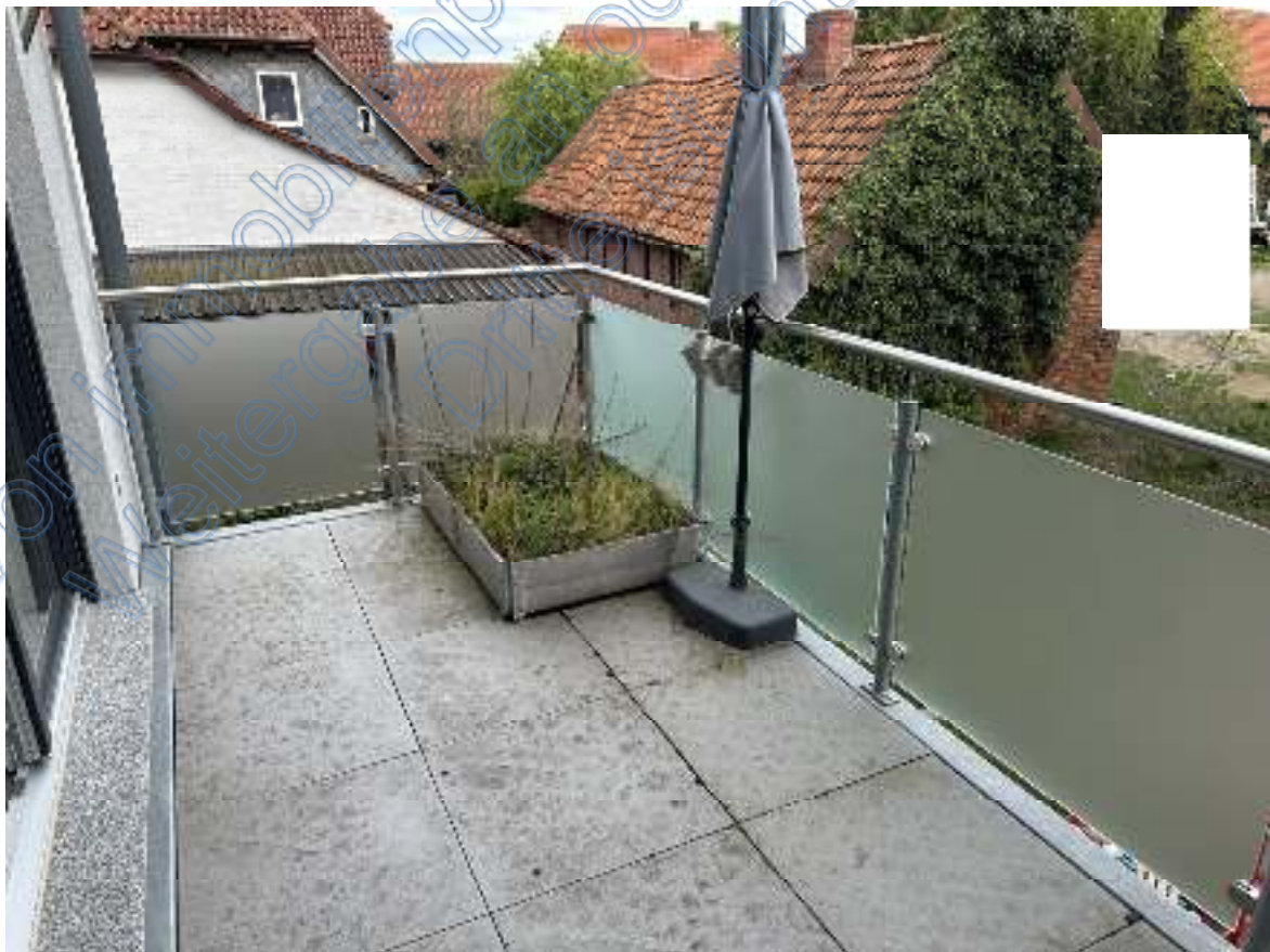
Bild 27: Ausschnitt – Balkon ( Mehrfamilienhaus mit sechs Wohneinheiten Wohnung 03 OG).
