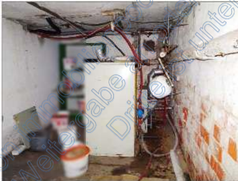
Foto 14 - gemischt genutztes Gebäude - Heizraum KG
