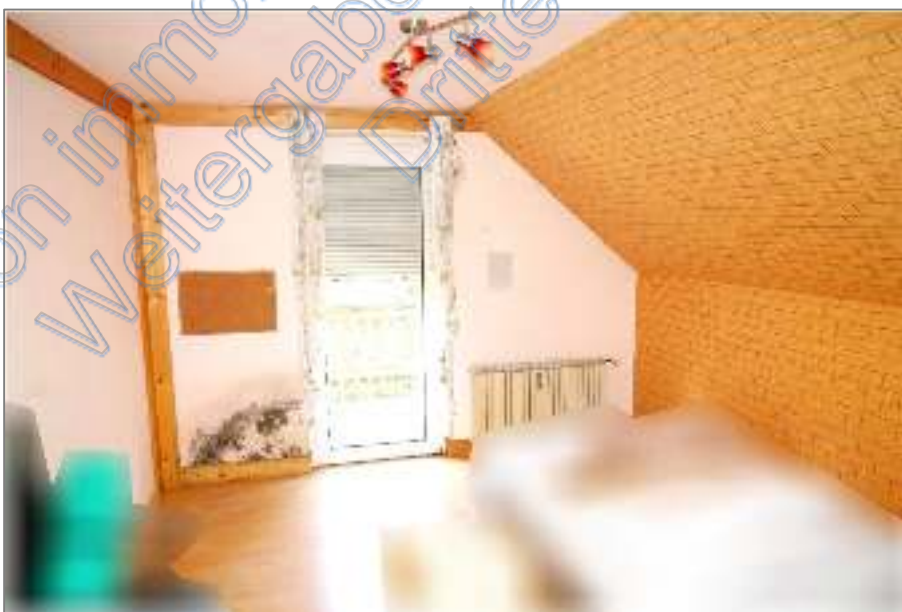
Foto 21 - Wohnhaus - Schlafzimmer DG - Wände mit Schimmelbefall
