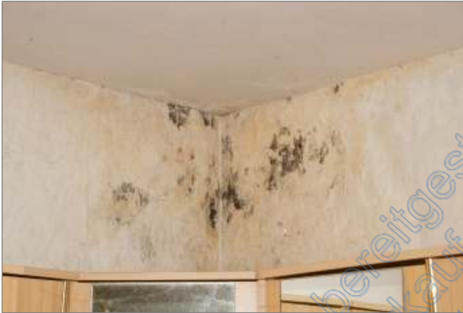
Foto 14 - Wohnhaus - Schlafzimmer EG mit Schimmelbefall
