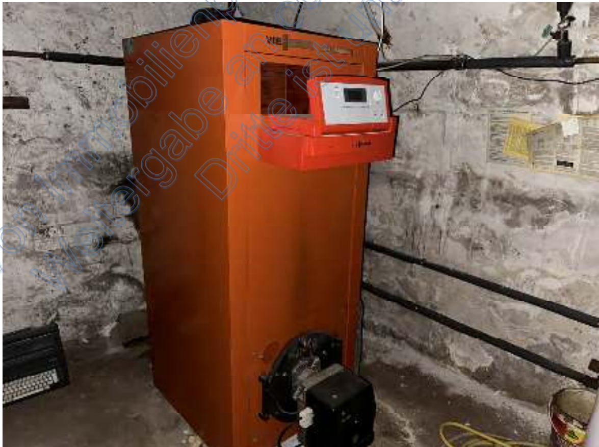
Bild 34: Ausschnitt – Heizungsanlage im sechsten Gewölbekellerraum (Wohn- & Geschäftshaus KG).
