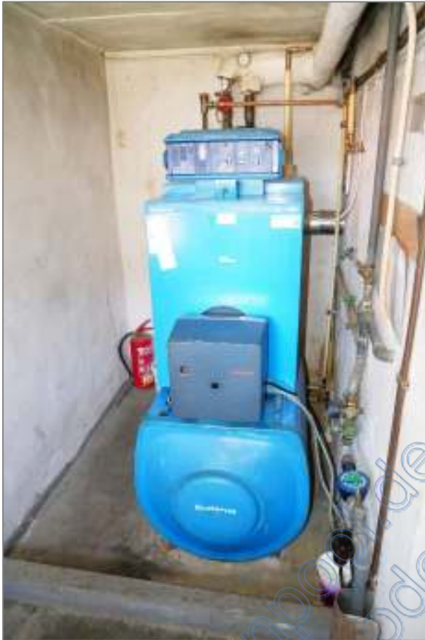
Foto 8 - Wohnhaus - Heizung KG
