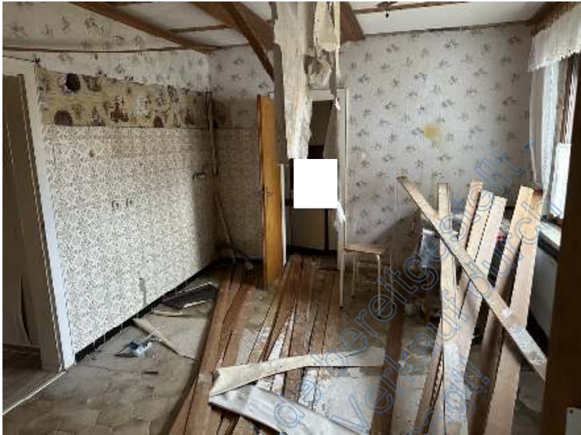
Bild 23: Ausschnitt – Küche mit Wasserschaden Richtung offener Tür zum Abstellraum ( Wohnhaus EG ).
