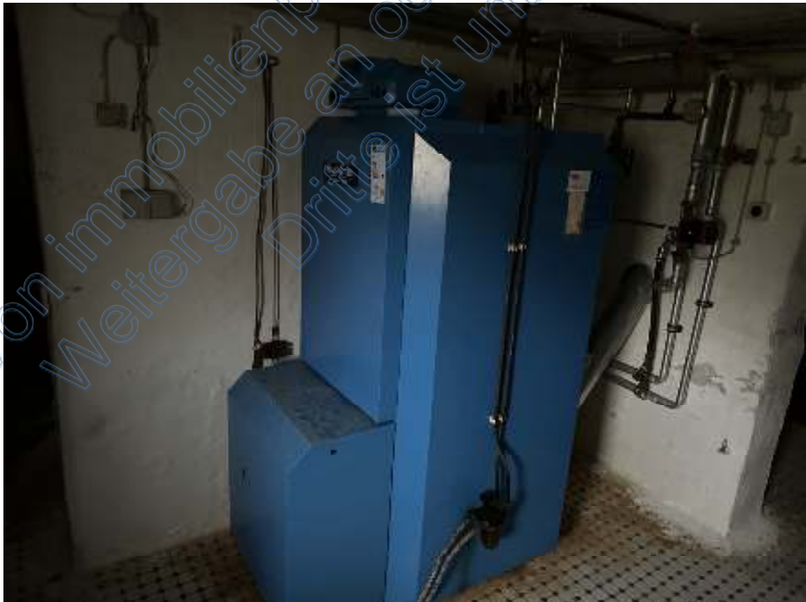
Bild 40: Ausschnitt – Heizungsanlage im Kellerraum 4 (Wohnhaus KG).
