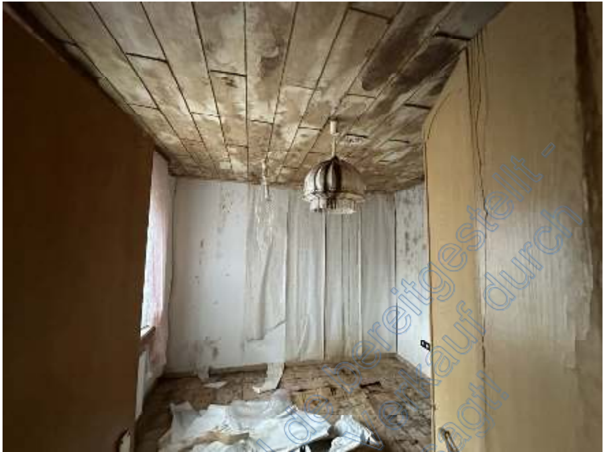
Bild 19: Ausschnitt – Zimmer 1 mit Wasserschaden (Wohnhaus EG).
