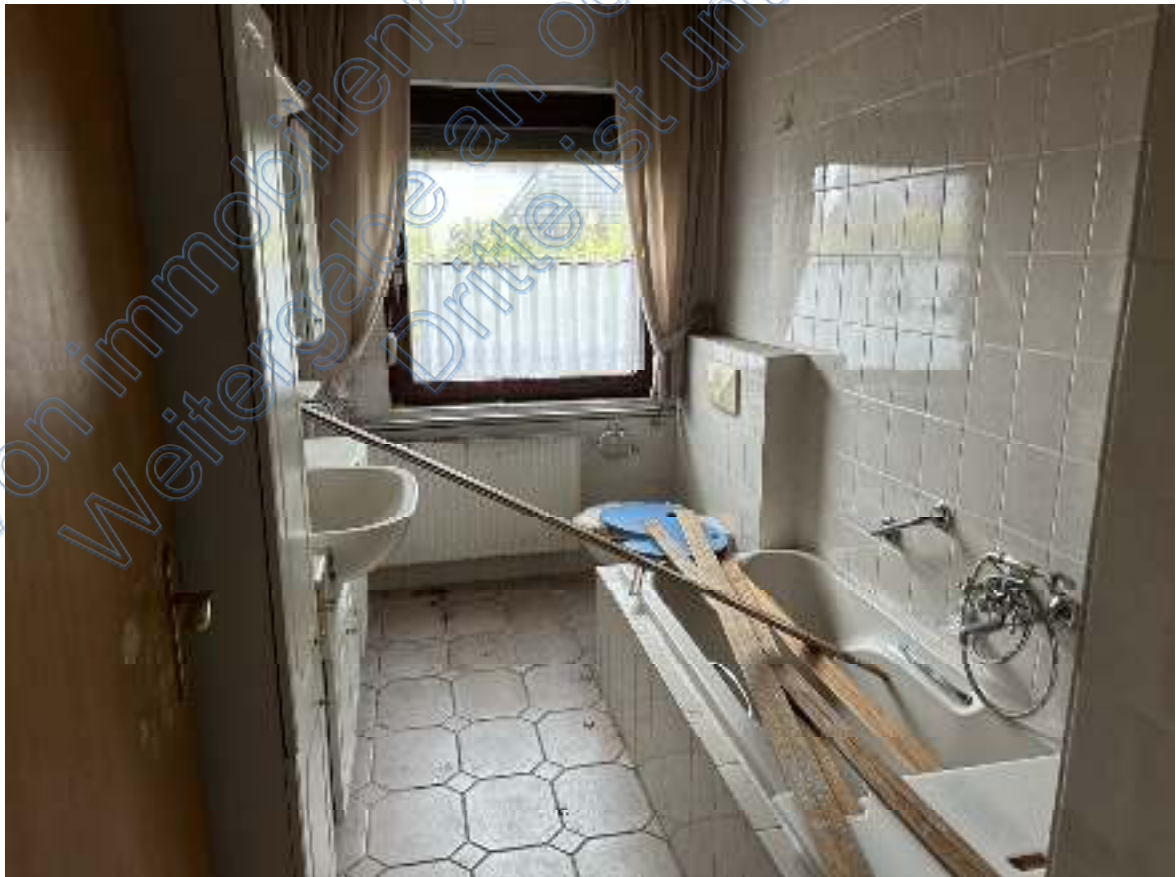
Bild 20: Ausschnitt – Bad mit Wasserschaden (Wohnhaus EG).
